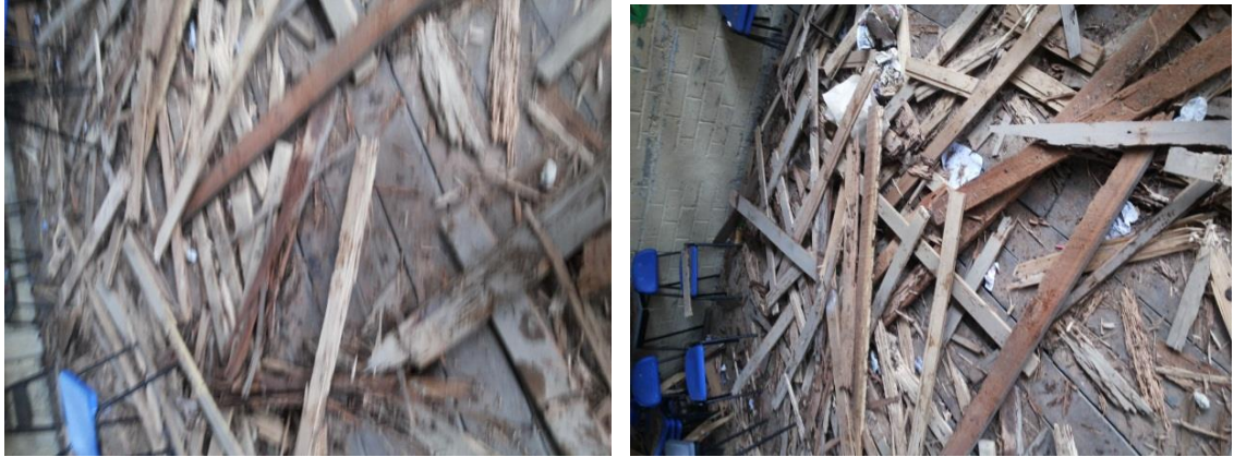
Foto 20. Caída del cielo raso del salon de clases. Por Eugenia Cuenu
