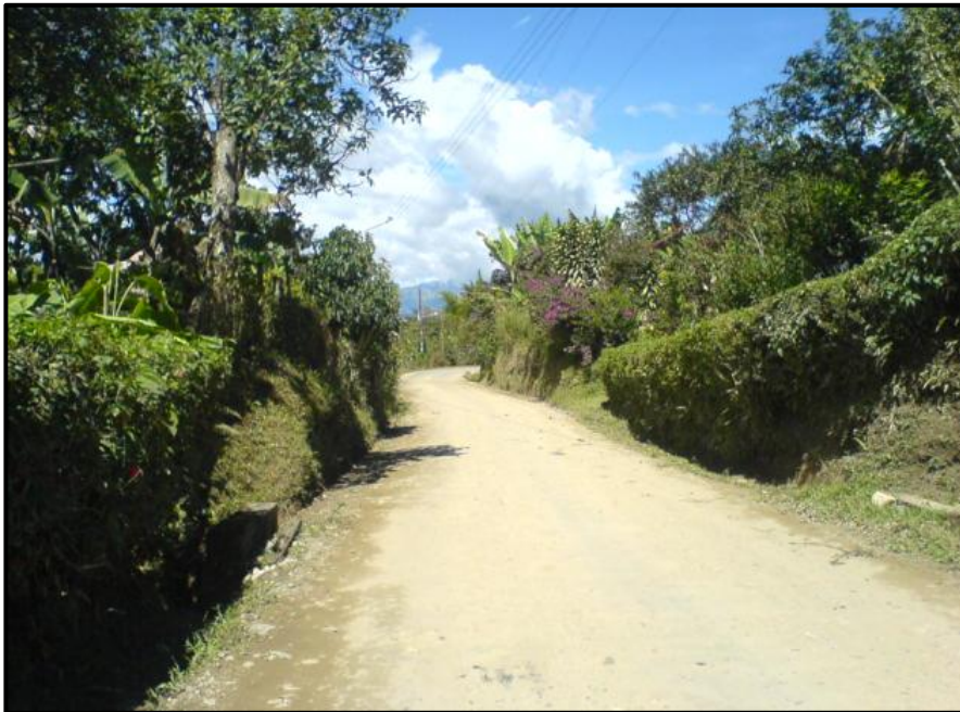
Fotografía N° 8. Estado de la vía sector Los Tendidos
