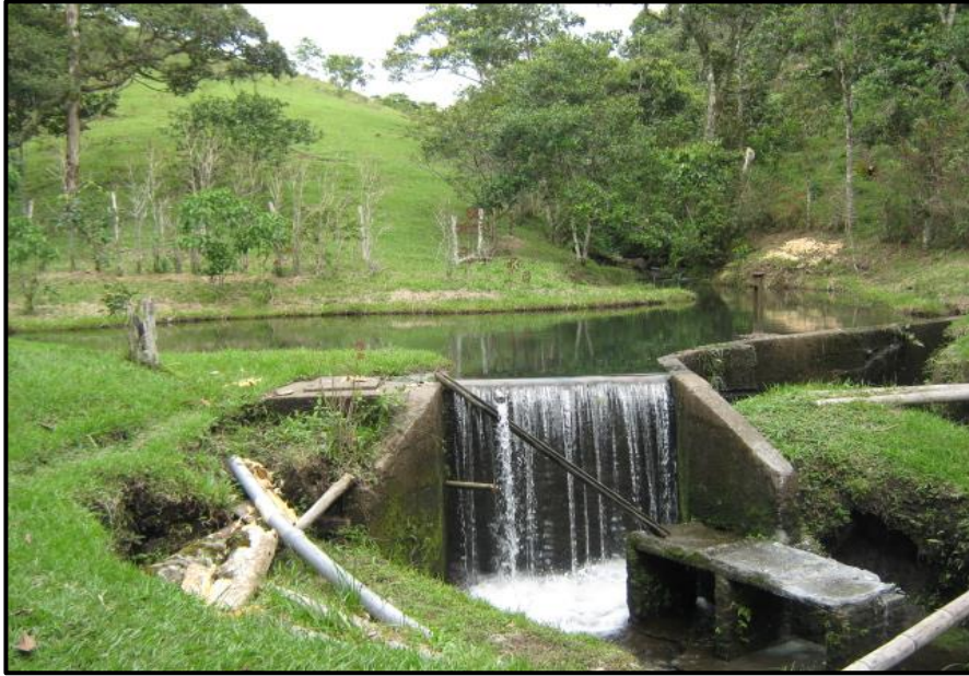
Fotografía N° 5. Bocatoma acueducto Vereda Los Tendidos
