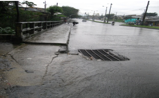
Cuando llueve las calles de Popayán se inunda los sistemas de desague están deteriorados
