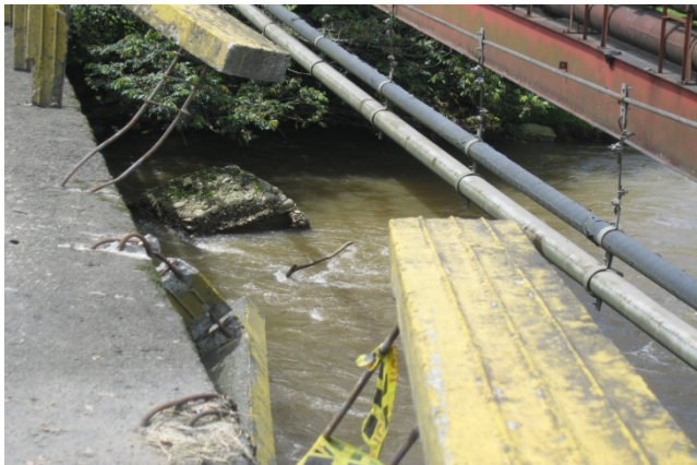
Daño aún no reparado del puente (paso del Río Cauca sobre la Autopista)
