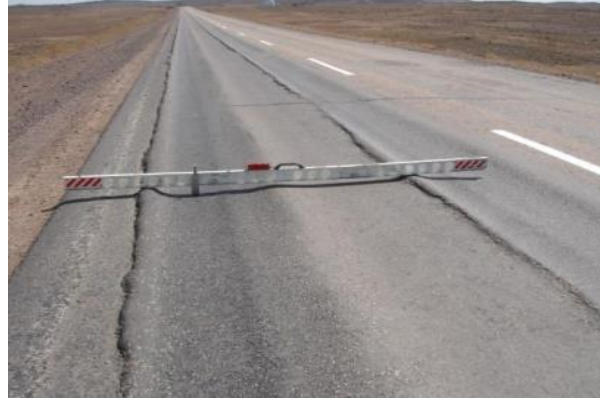
Figura 5. Deformación Permanente en Pavimento Asfáltico (profundidad de la huella 60mm aprox.) (Km 1903.1 – Región Karaganda, Kazakhstan)
