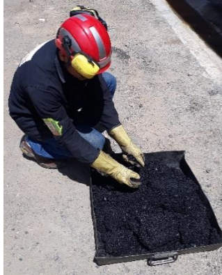
Fotografía 1. Disgregación Mezcla Asfáltica
