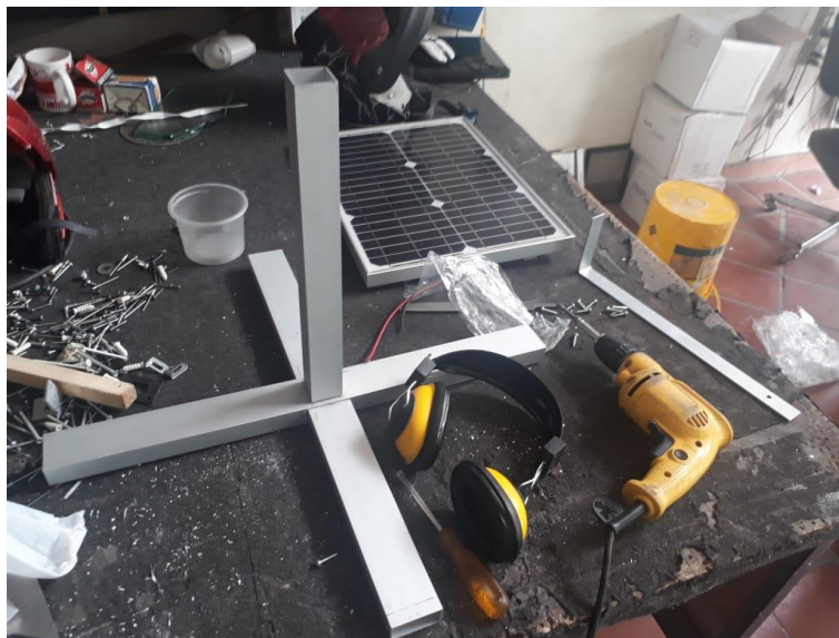
Figura 3.15 Base de los sistemas de seguimiento. (Fuente: propia)
