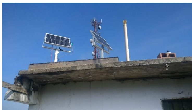
Figura 3.20 Sistemas de seguimiento en funcionamiento
