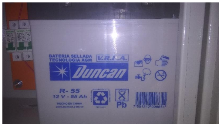
Figura 2.11 Batería del sistema de potencia. (Fuente: propia)
