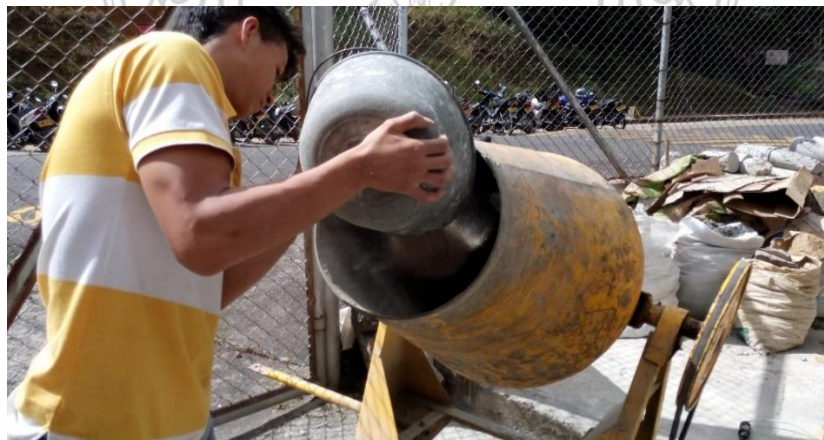
Foto 14. Adición de los materiales en la mezcladora para la preparación de la bachada de mortero de pega.
