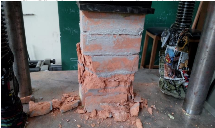
Foto 32. Falla a compresión de prisma 4
