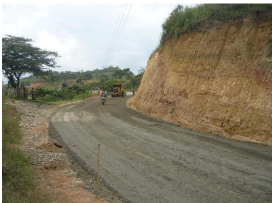
Imagen No.13 Obras sin señalización
