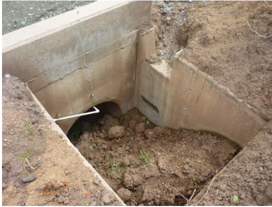
Imagen No. 17 Alcantarilla tapada
