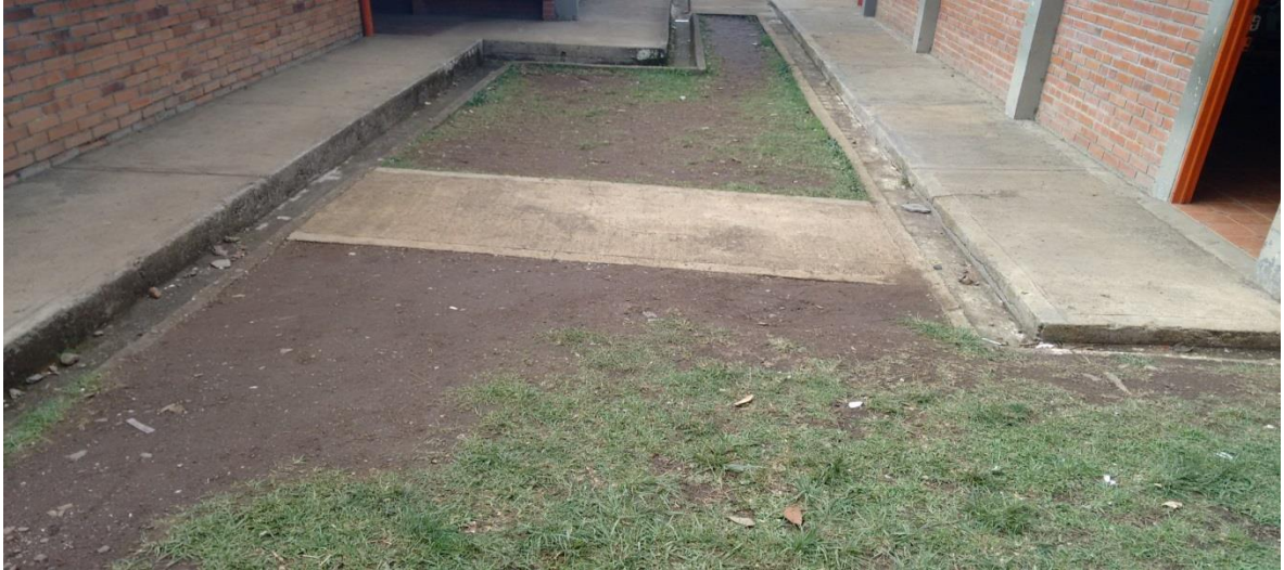
Figura No.21 Problemas con la nivelación del terreno.
