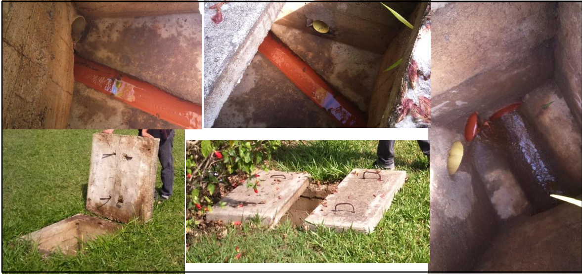
Figura No. 25 Estado de cajas de recolección y tuberías.
