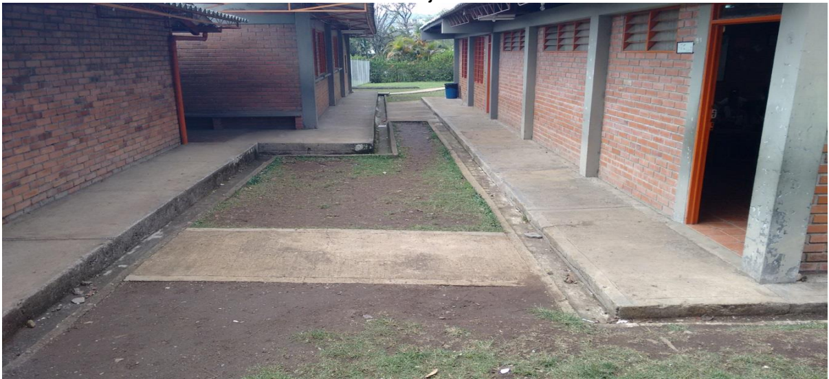
Figura No. 22 No existe canal que se encargue de recoger el agua proveniente del tejado.
