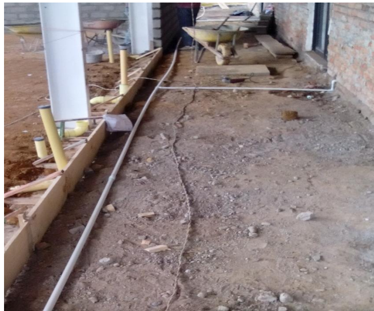
Figura N° 70 : Tubería de agua potable.
