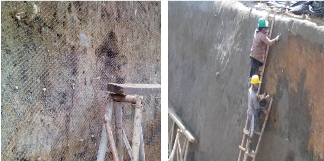
Figuras N° 8 y 9: Estabilidad de taludes.
