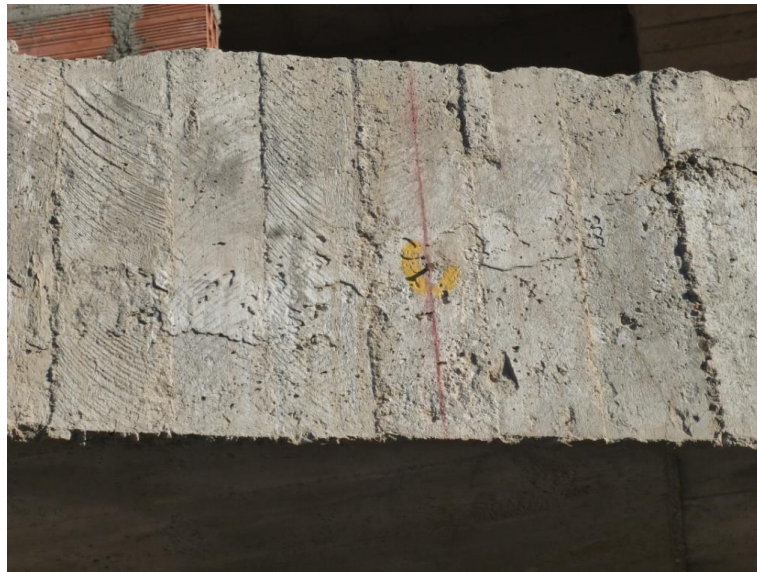
Figura No 3. Detalle de referencia en placa
