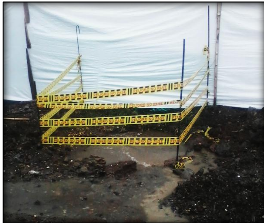
Imagen 49 Falta de limpieza en cámara de inspección
