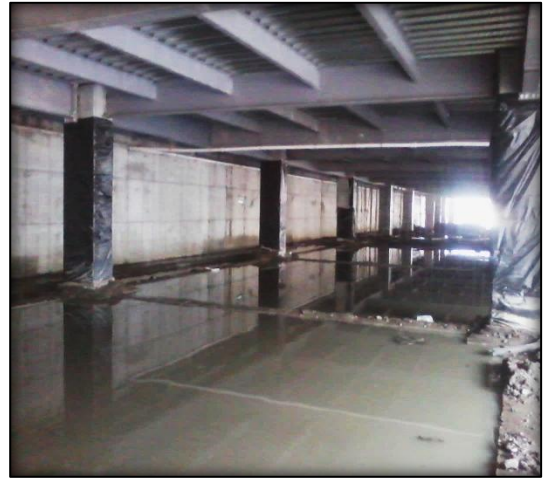
Imagen 40 Módulos Afectados por Lluvias.
