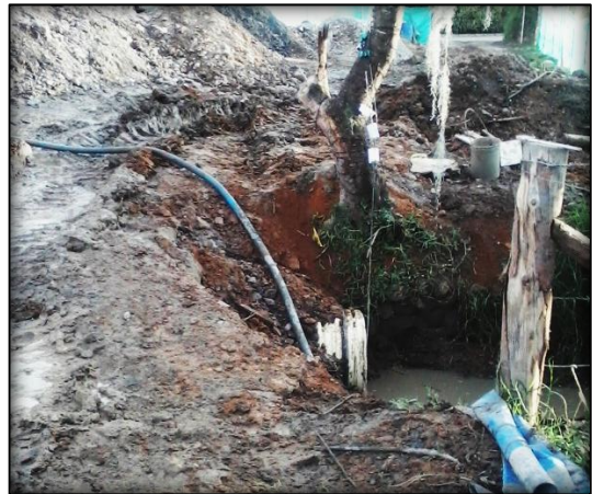
Imagen 51 Descarga de Aguas Lluvias.
