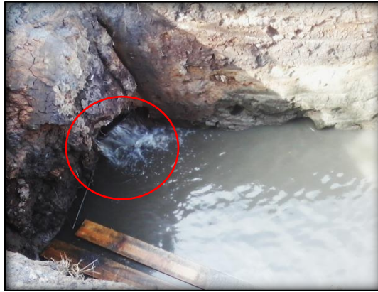
Imagen 45 Tubería Rota e ingreso de agua al sótano
