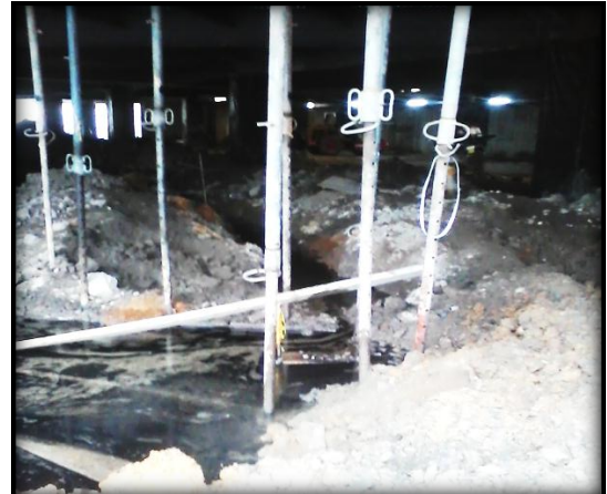
Imagen 44 Barrera para Impedir el Ingreso de Aguas Lluvias.
