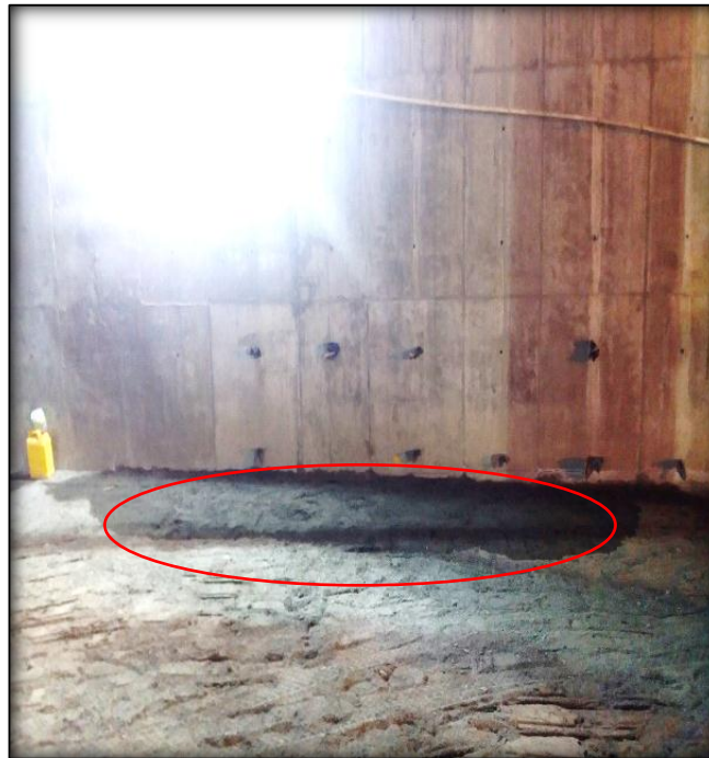
Imagen 29 Problemas de Humedad en la Sub-Base.
