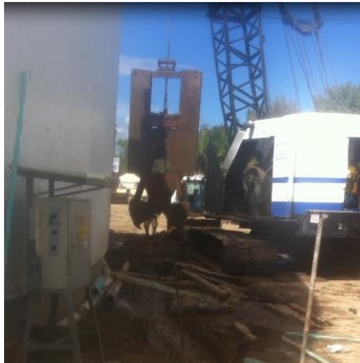
Figura N° 32. Almeja de construcción realizando excavación de las zanjas para pantallas y barretes (Fuente: propia).
