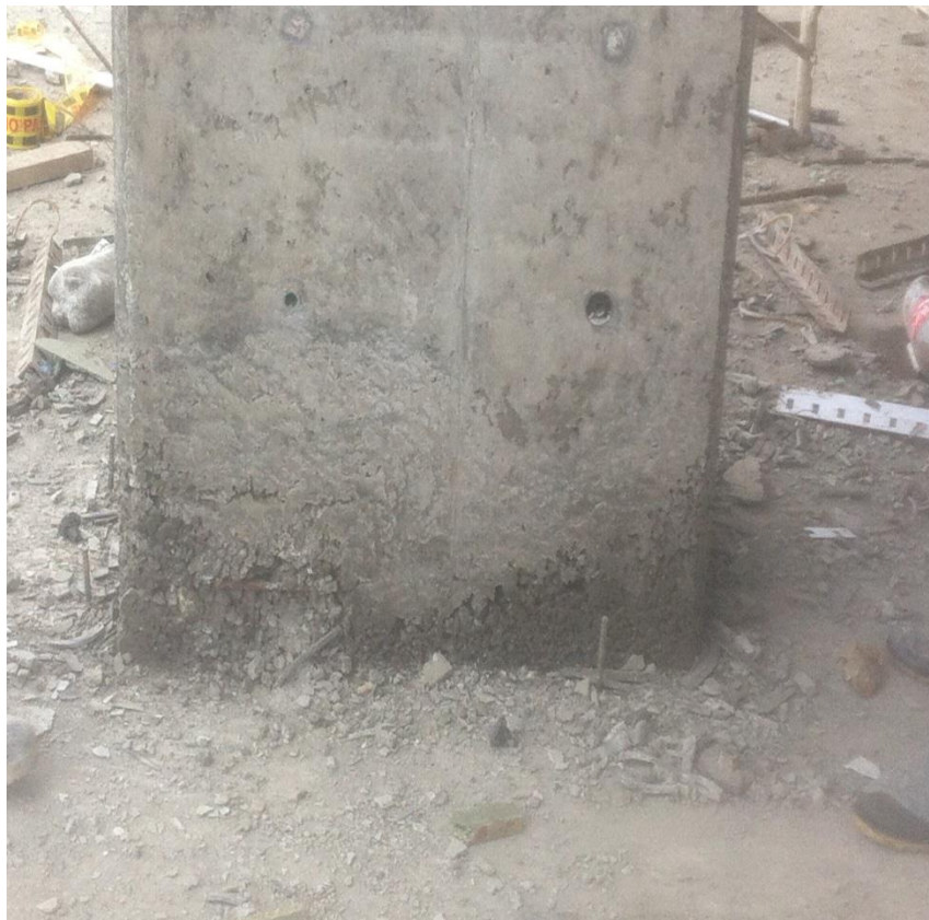
Figura N° 18. Hormiguero presente en la base de una columna (Fuente: propia).
