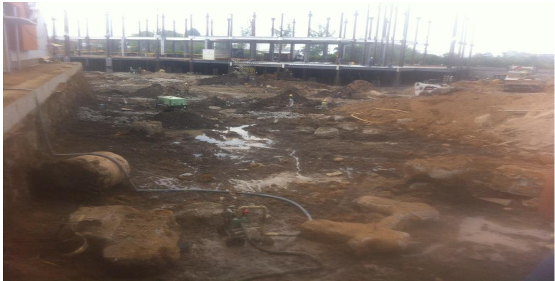
Figura N ° 29. Estado inicial de la construcción (Fuente: propia).
