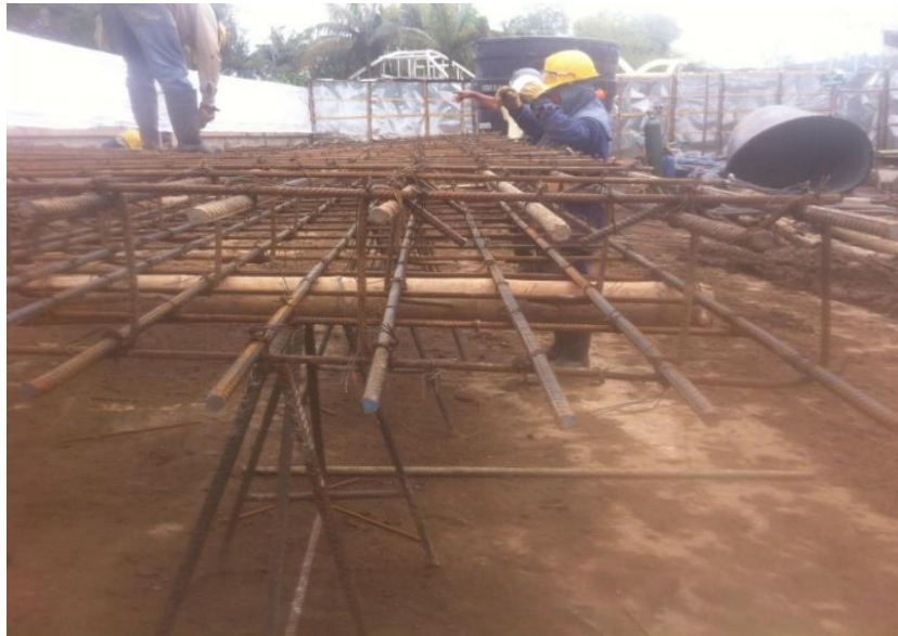
Figura N° 34. Personal realizando el amarre del refuerzo para las pantallas y barretes (Fuente: propia).
