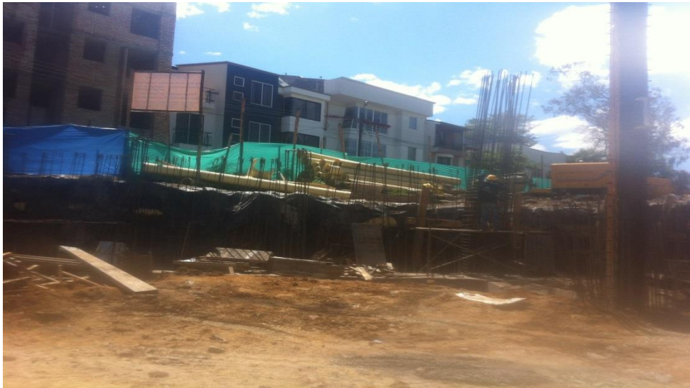
Figura N°30. Estado inicial de la construcción (Fuente: propia).
