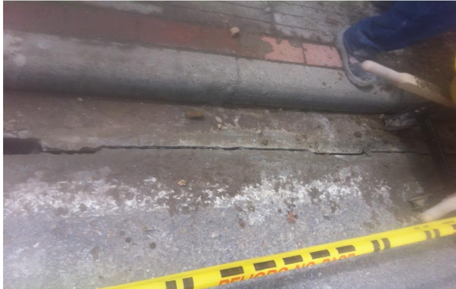
Figura N° 57. Grieta sobre carrera 15 (Fuente: propia).
