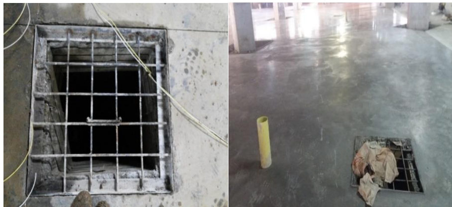
Fig. N°61. Caja de inspección y sifones a la altura de pavimento.
