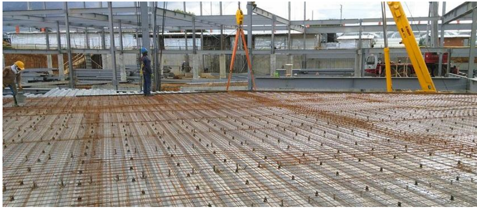
Figura No. 39 Colocación de malla electrosoldada y silletas FORZA para garantizar recubrimiento. Fuente propia.
