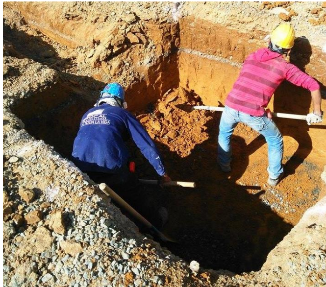
Figura No. 10 Excavación y perfilado de zapata realizado a mano. Fuente propia.
