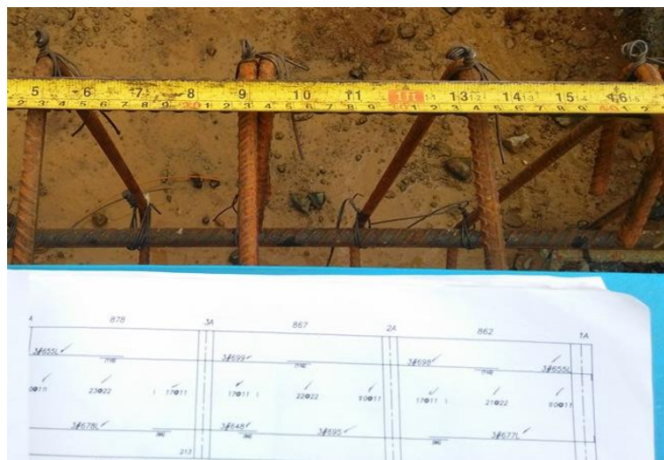
Figura No. 16 Chequeo de acero de refuerzo en vigas de cimentación. Fuente propia.
