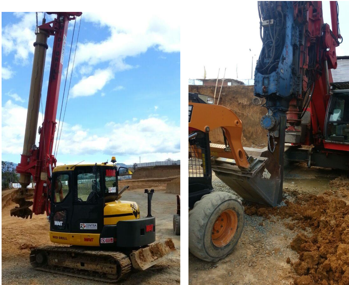
Figura No. 8 Midi Drill Mait usada en perforación de geopier- Mini cargador vertiendo agregado en perforación de geopier. Fuente Propia.
