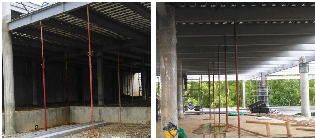
Figura No. 40 Apuntalamiento temporal de vigas y viguetas para evitar cualquier tipo de accidente. Fuente propia.
