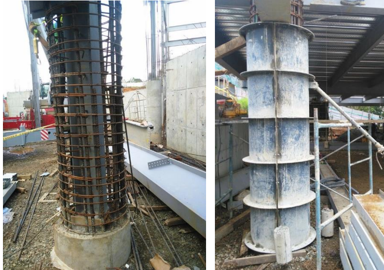
Figura No. 33 Colocación de acero en columna- Chequeo de plomo en formaleta de columna. Fuente propia.
