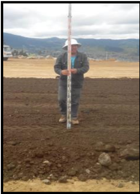
Figura 61. Chequeo de niveles. (Fuente: Propia)
