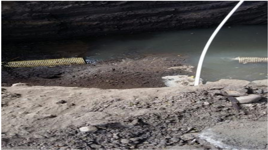
FIGURA 16. Tubería de 8" cubierta por material de la excavación y aguas servidas.
