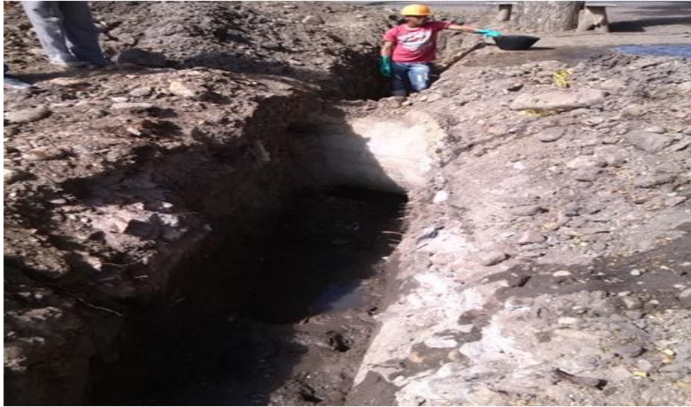
FIGURA 7. Obrero sin elementos de protección personal.
