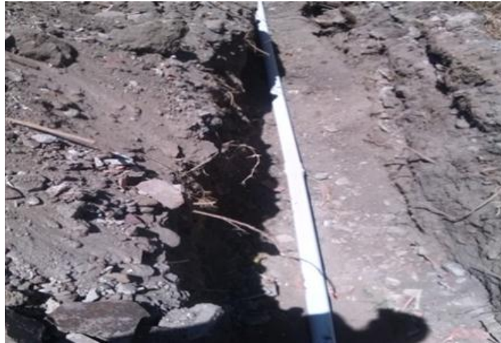
FIGURA 6. Fondo de la zanja sin cama de arena en tubería de red de acueducto.
