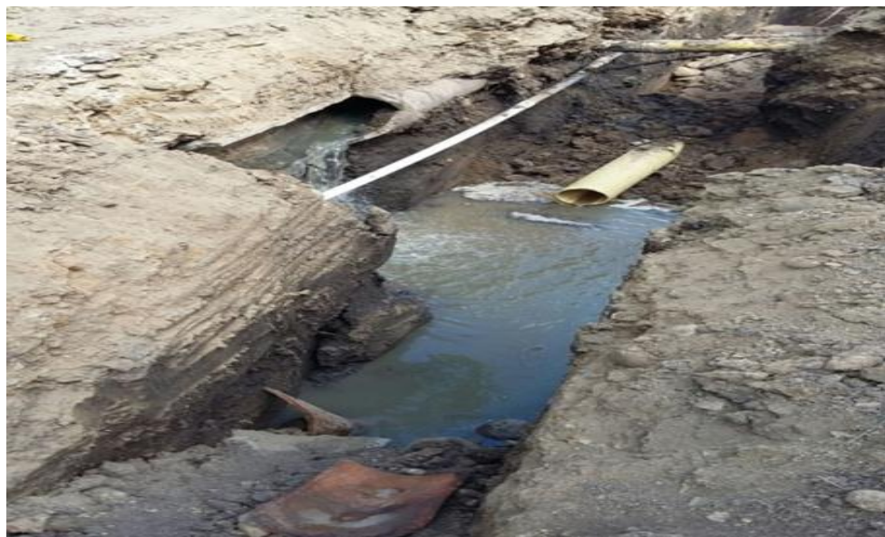
FIGURA 15. Tubería de gres rota por excavaciones.
