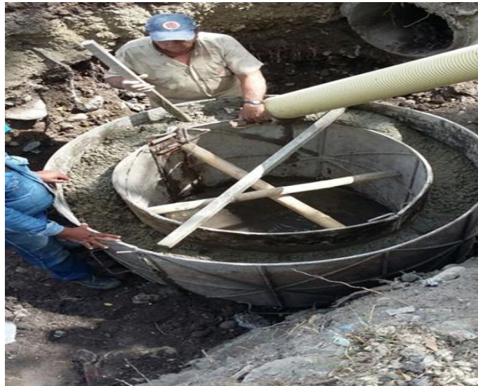
FIGURA 17. Construcción de pozo con formaleta desalineada.
