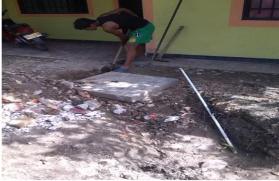
FIGURA 13. Acometida de alcantarillado y acueducto por la misma vía.
