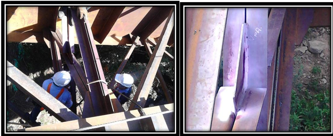
FIGURA 70: ENSAYO DE TINTAS REALIZADO A LA SOLDADURA.
