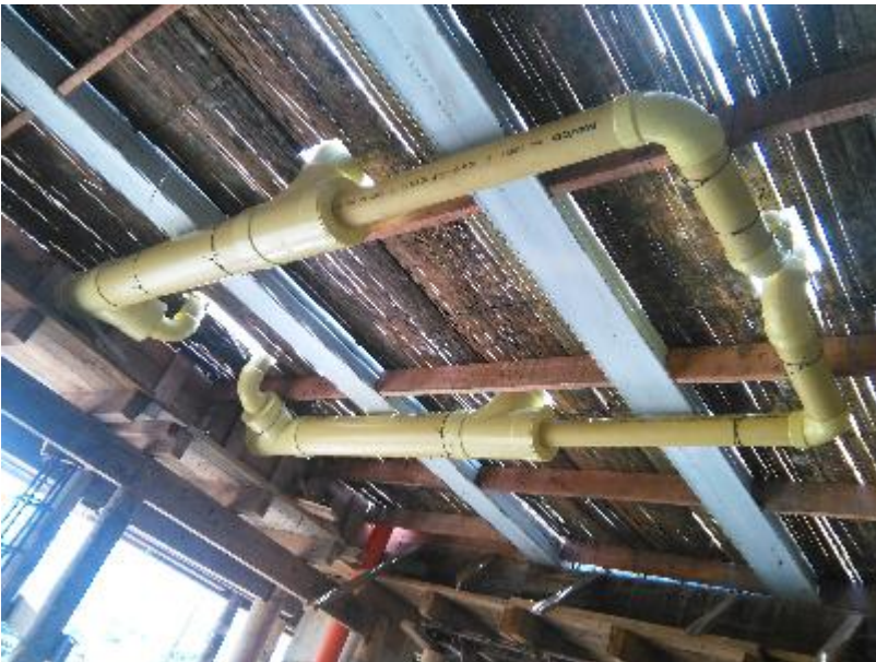
Figura No 28 Ubicación de tubería sanitaria. Fuente: Propia.
