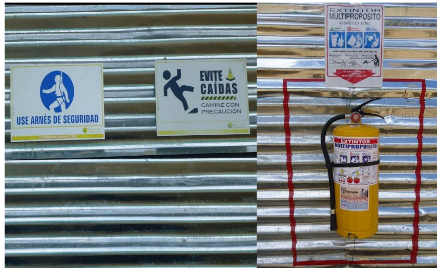
Figura No. 9 Señalización
