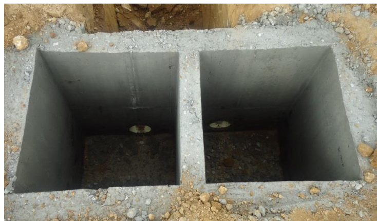
Figura No. 26. Cajas domiciliarias
