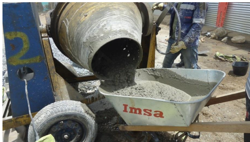
Figura No.47 Mezcladora para concreto en obra
