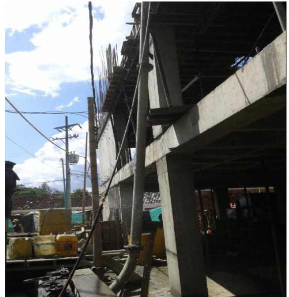
Ilustración 41. Tubería de bombeo.
