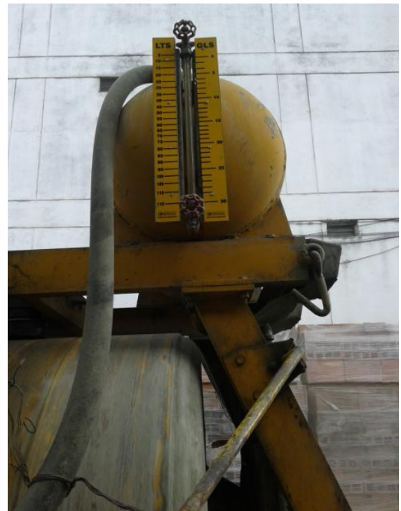
Ilustración 44. Tanque cilíndrico con medidor de agua.
