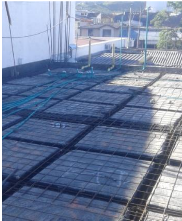
Ilustración 39. Instalaciones eléctricas e hidrosanitarias.
