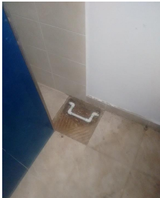
Figura 34. Daño Hidráulico. Fuente Autor
