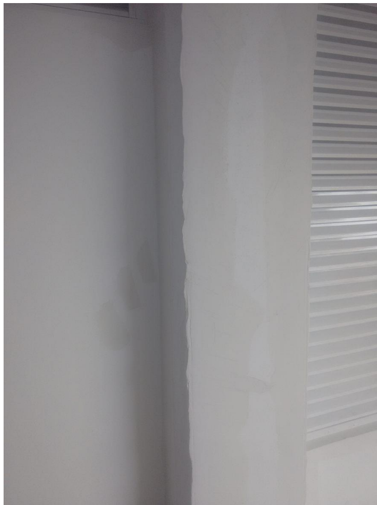
Figura 33. Verificación De Filo Regular Estucado. Fuente Autor
