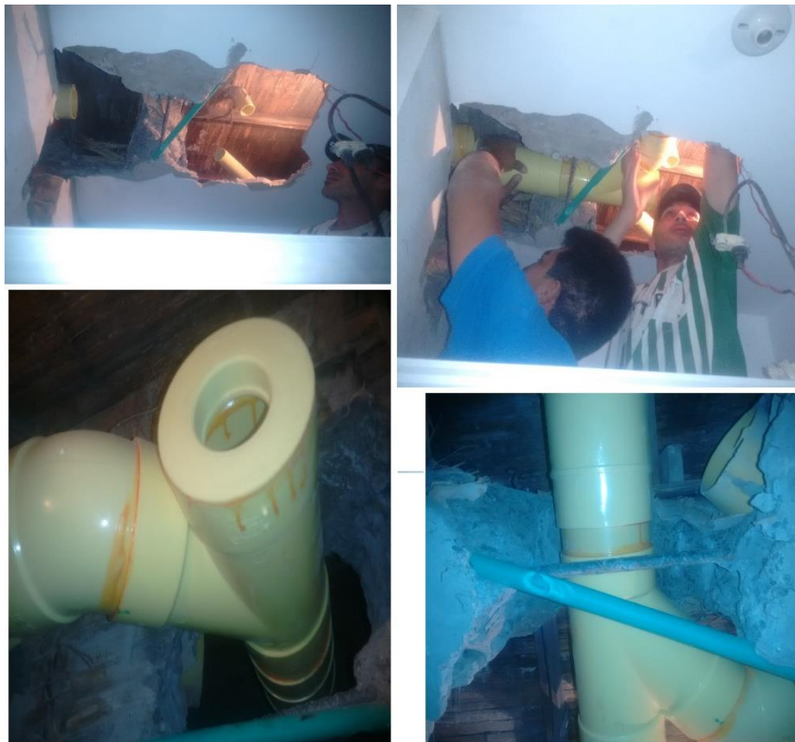
Figura 36. Identificación y Reparación De Daño Hidráulico. Fuente Autor
