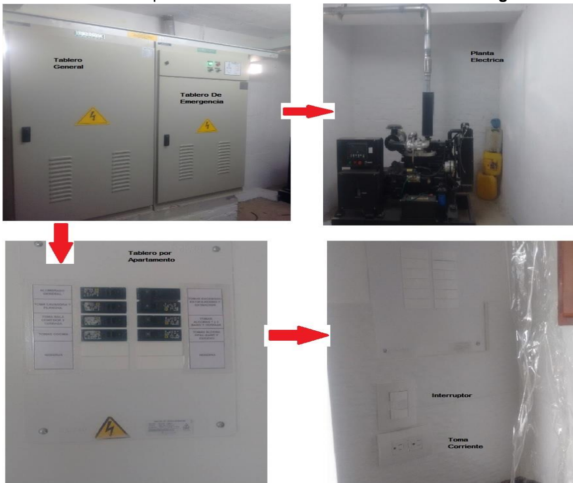
Figura 24. Instalaciones Eléctricas. Fuente Autor
