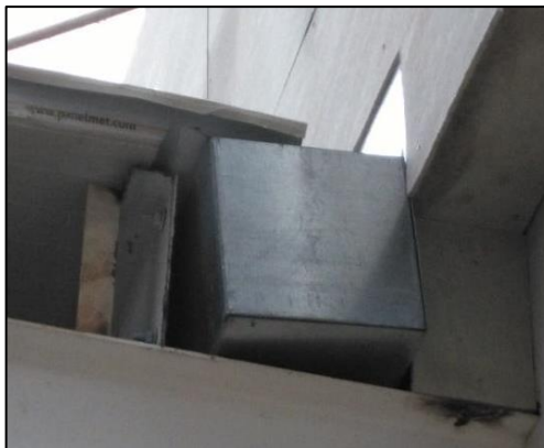
Figura No. 45 Canaleta en cubiertas con evacuación de aguas diseñada por sistema convencional. Fuente propia
