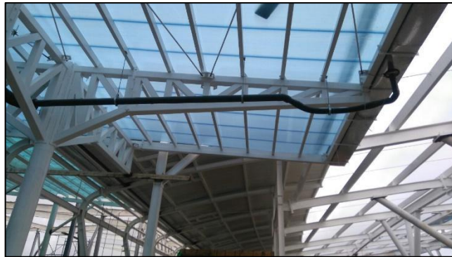
Figura No. 60 Alargamiento de manguera flexible a colector horizontal. Fuente propia
