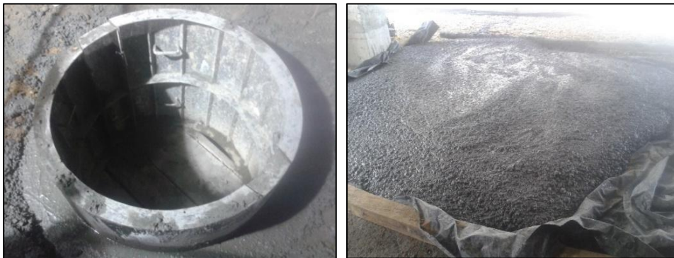
Figura No. 21 Fundición de cámara de inspección con concreto 3000psi. Fuente propia.
