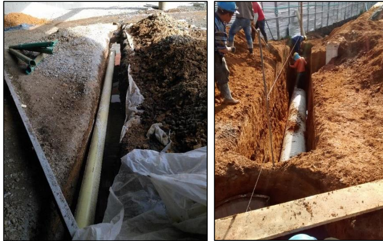
Figura No. 29 Tendimiento de tubería bajo chequeo de pendiente de diseño. Fuente propia.
