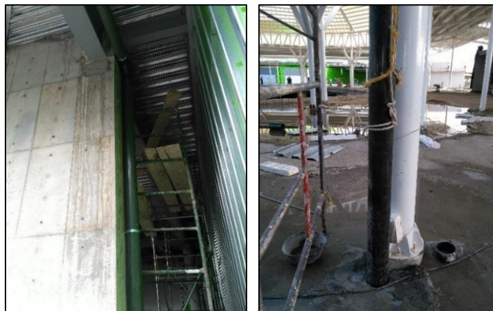
Figura No. 64 Bajante en tubería PVC-QS de 160mm. Fuente propia
