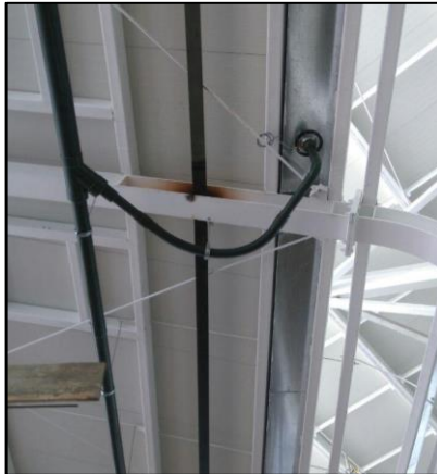
Figura No. 59 Empate de manguera flexible a colector horizontal con codo 45° y Yee. Fuente propia
