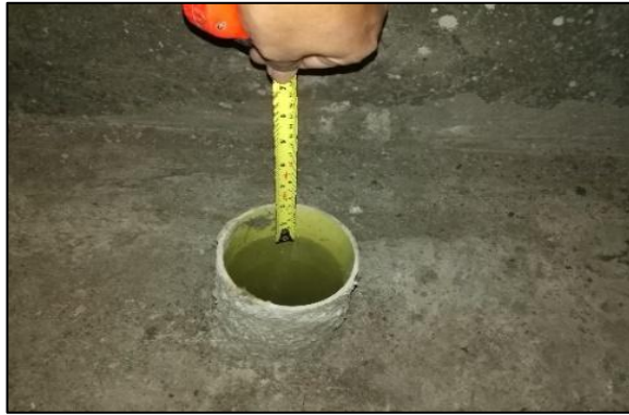
Figura No. 73 Medida inicial en tubería de desagües. Fuente propia
