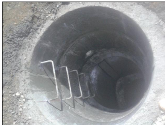
Figura No. 23 Gradillas en cámara de inspección. Fuente propia.
