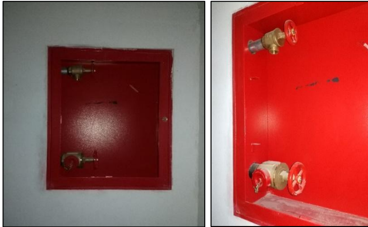
Figura No. 70 Gabinetes en Cine Colombia en Piso 2. Fuente propia
