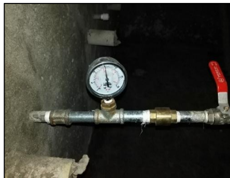
Figura No. 71 Medida inicial en manómetro 150psi. Fuente propia
