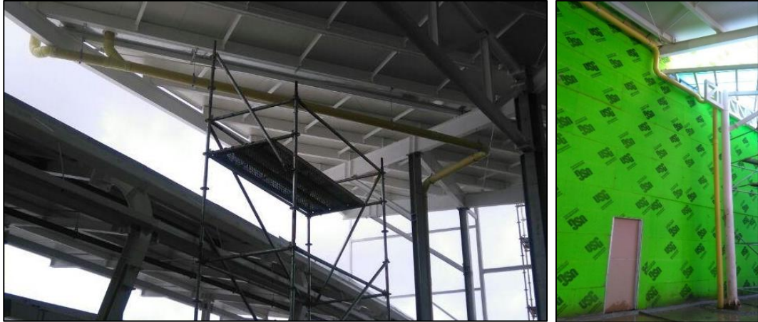
Figura No. 48 Tubería de recolección de aguas lluvias hasta bajante. Fuente propia
