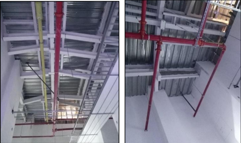
Figura No. 66 Recorrido de tubería de Red Contra Incendios en Piso 2 y Piso 1. Fuente propia
