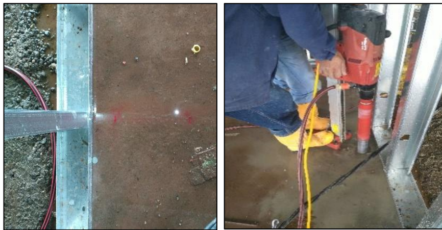
Figura No. 35 Ubicación de pase en campo y fijación de Sacanúcleos. Fuente propia.
