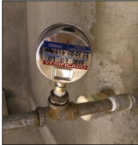
Figura No. 72 Datos de manómetro. Fuente propia
