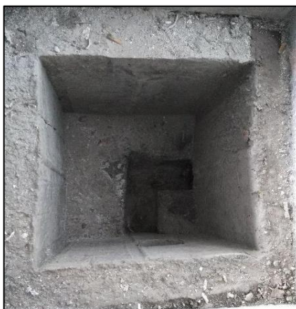
Figura No. 16 Cañuelas en cajillas de inspección. Fuente propia.
