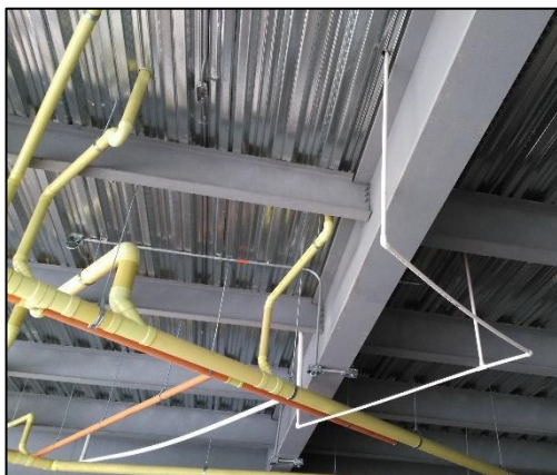
Figura No. 12 Araña de suministro en baños. Fuente propia.
