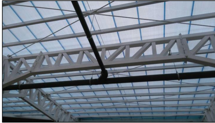
Figura No. 61 Soportes deslizantes horizontales en colector horizontal. Fuente propia
