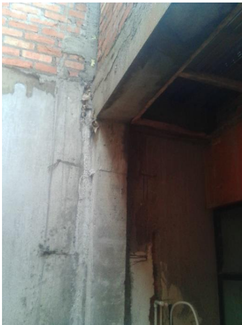
Imagen 22. Obra 3, columna y viga con voladizo.
