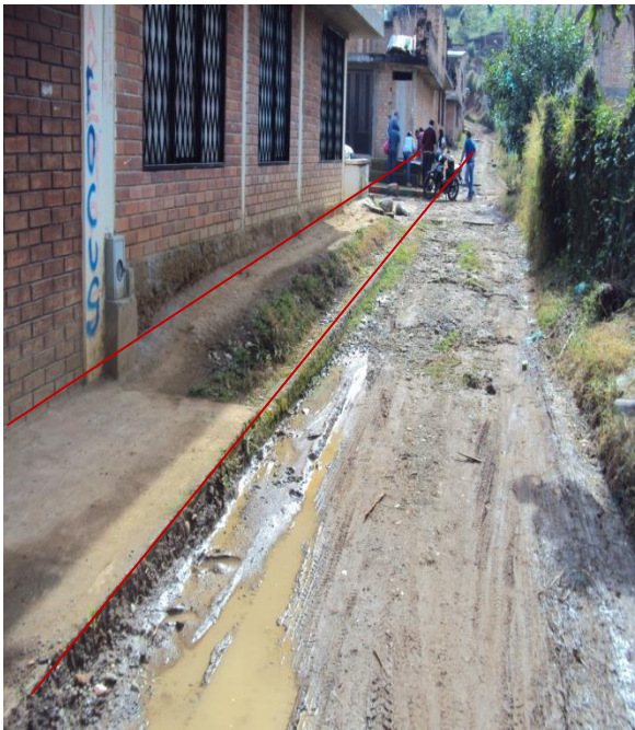
Figura37. Construcción de obras complementarias de la infraestructura municipal de transporte (andenes y sardineles)de la calle 27AN desde la carrera 2 hacia la carrera 1 – carrera 1 desde la calle 27AN hacia la calle 27BN. Barrio Ucrania
