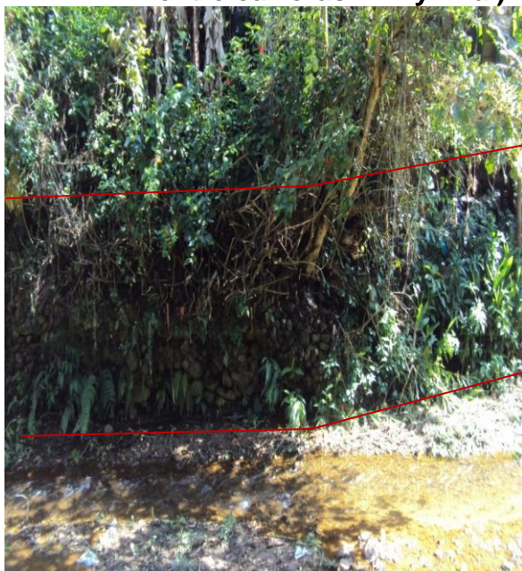
Figura41. Construcción de obras complementarias de la infraestructura municipal de transporte (muro de contención) en la margen derecha del río ejido (parte posterior de la calle 13 bis entre carreras 11E y final). Barrio Avelino UII
