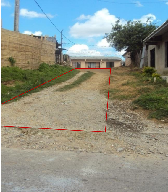
Figura14. Construcción de placa huella en la vía Carrera 10 A entre calles 30 hacia carrera 11. Barrio Jorge Eliecer Gaitán
