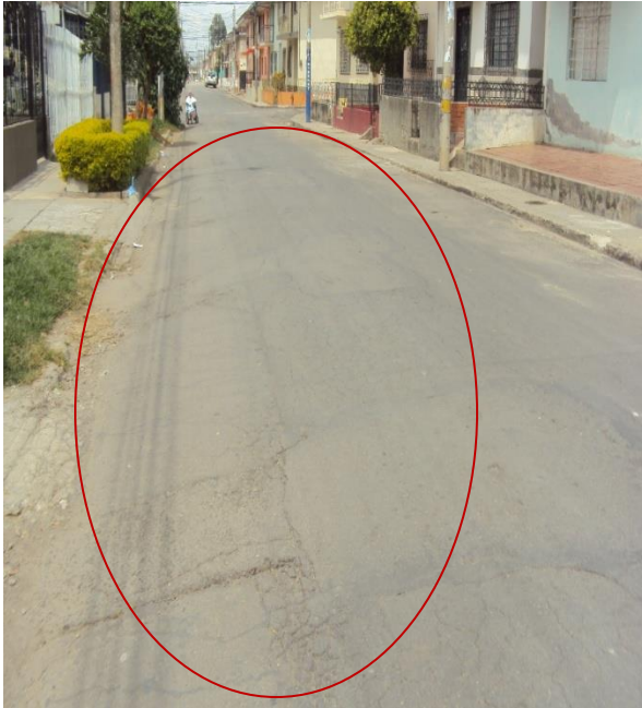
Figura10. Pavimentación desde la carrera 10 entre las calles 11 a la 11A.Barrio San Camilo y alrededores
