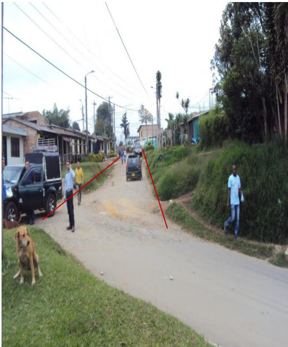
Figura33. Pavimentación de la carrera 19 desde la calle 60N hacia la calle 62N. BarrioLa Esperanza Norte
