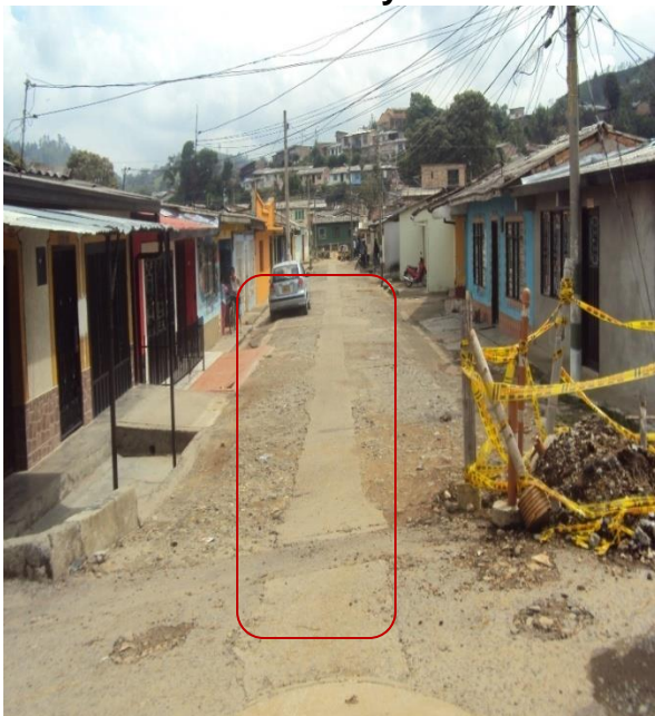
Figura11. Pavimentación y sardineles de la carrera 5 entre calles 17 y 18. Barrio los Sauces
