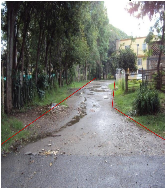
Figura50. Pavimentación calle 8 desde la carrera 23A hacia la carrera 27B. Urbanización Perpetuo Socorro
