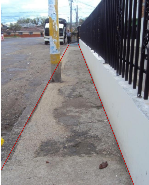
Figura16. Construcción de andenes en la vía carrera 10A entre la carrera 11 hacia la carrera 14 – Barrio José Hilario López
