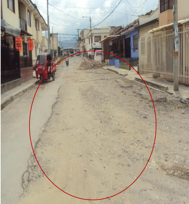
Figura8. Pavimentación desde Calle 11 entre las carreras 11A y 12. Barrio las Américas y Aledaños
