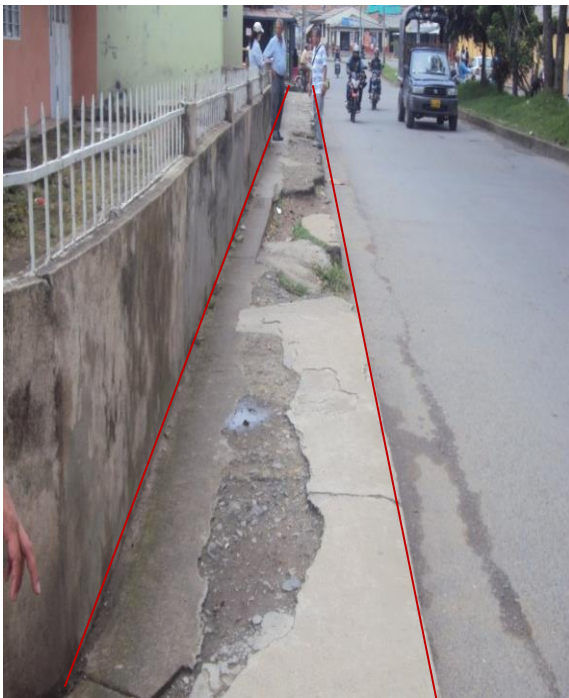
Figura17. Construcción de Andenes en la vía calle 32 A con Carrera 8. Barrio Primero de Mayo
