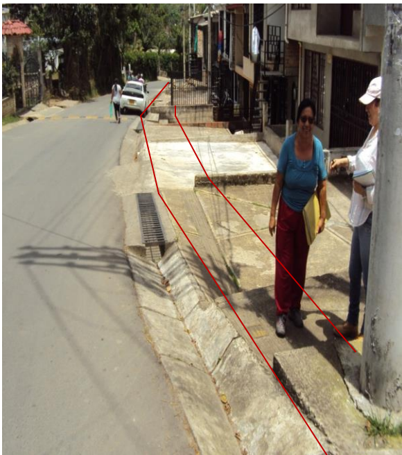
Figura45. Construcción de obras complementarias de la infraestructura municipal de transporte (andenes y sardineles), de la carrera 18b desde el parque del Barrio Versailles La Ladera hacia la casa con nomenclatura carrera 18 No. 15-205.
