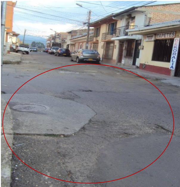
Figura4. Terminación de Pavimentación desde la casa No. 7N-21 Calle 7 Norte entre carreras 8A a 6B. Barrio Belalcázar
