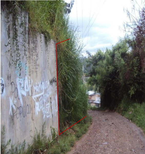
Figura29. Muro de contención sobre la calle 1 con carrera 45 con una longitud de 20 metros por una altura de 8 metros.
