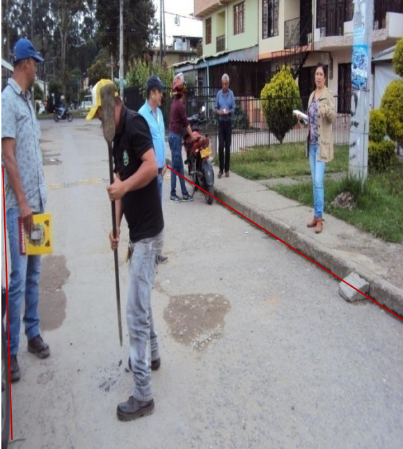
Figura38. Pavimentación de la carrera 13 desde la calle 13 hacia la calle 12. Barrio Colombia I etapa
