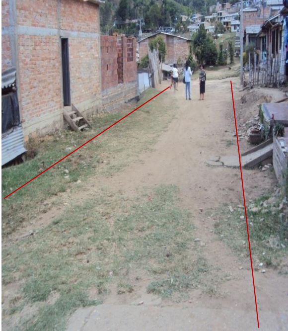
Figura20. Construcción de Pavimento en la calle 30A y Calle 30B con carrera 8 – Barrio Paz Sur
