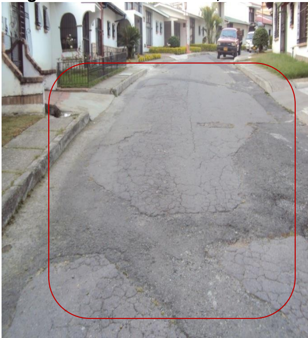
Figura3. Parcheo vía única, Circular 5A Norte. Barrio Loma Linda
