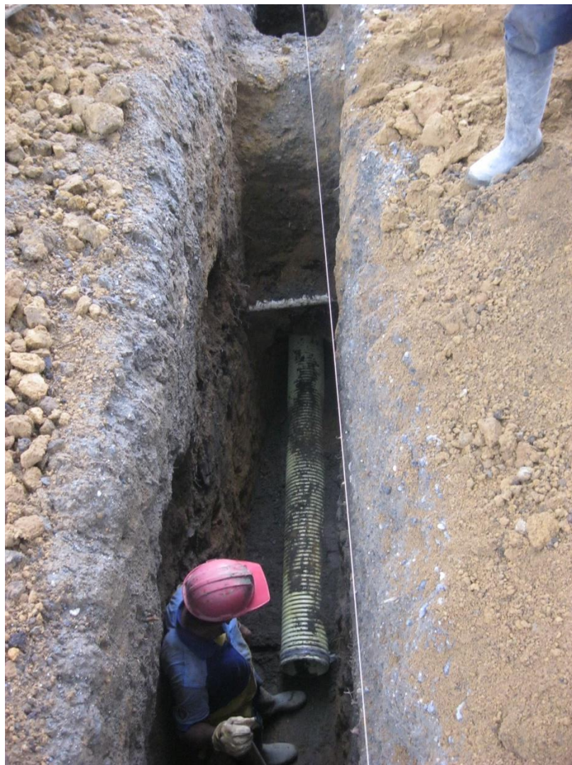
Figura N° 7: Instalación de tubería para la evacuación de aguas residuales de las Torres C y D.
