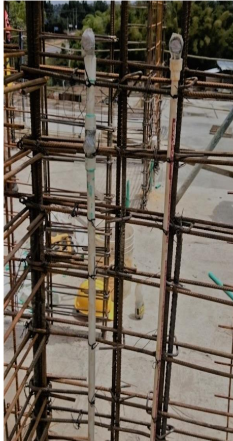
Figura N° 43: Puntos hidráulicos en muros.
