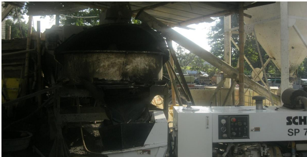
Figura N° 22: Planta mezcladora de concreto de la obra.
