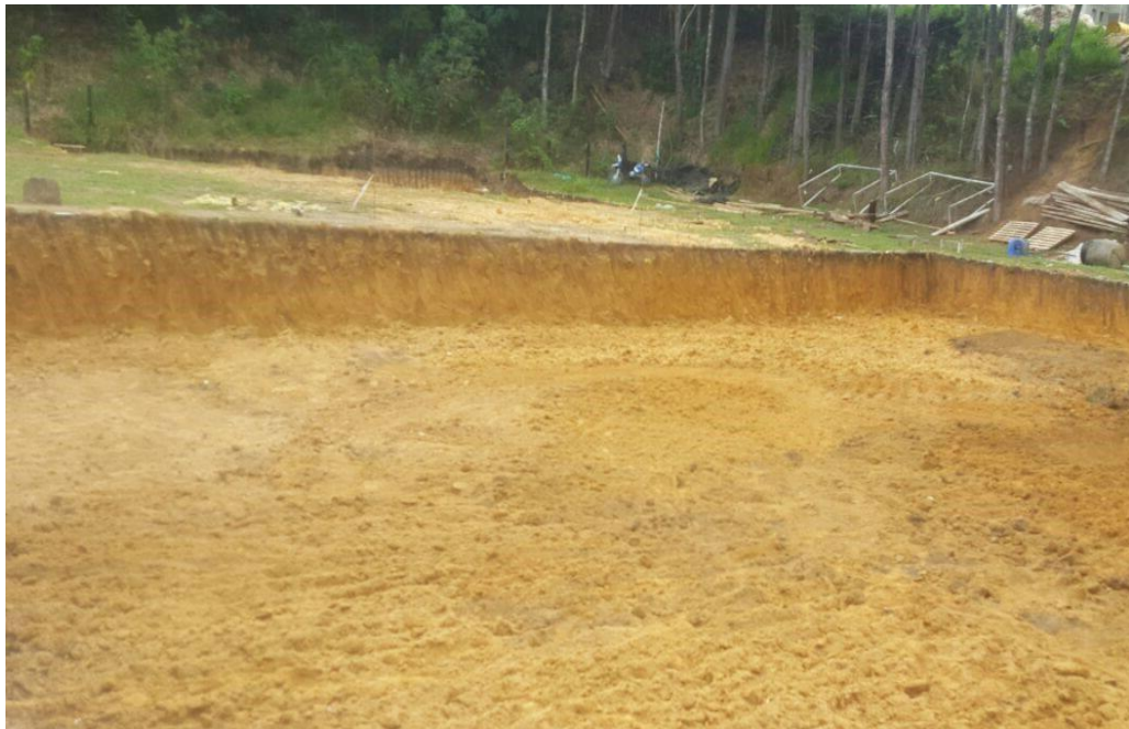
Figura N° 6: Excavación del terreno para construir la losa de cimentación de la Torre D.
