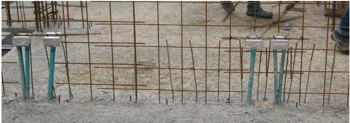
Figura N° 41: Red eléctrica empalmada con red anclada en la cimentación.
