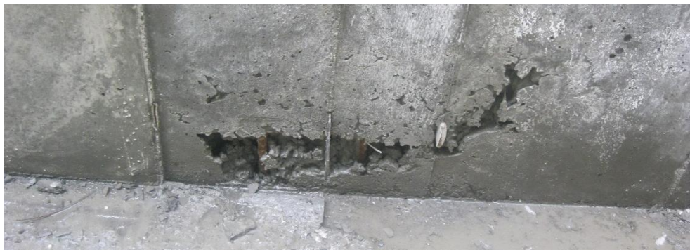
Figura N° 64: Error en fundición de concreto 2.
