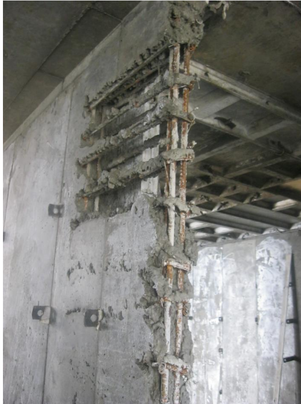
Figura N° 63: Error en fundición de concreto 1.
