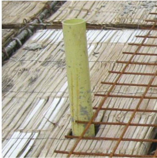
Figura N° 26: Paso de tubería sanitaria por casetones.
