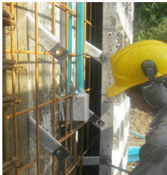
Figura N° 42: Red eléctrica para punto de interruptor en muro.
