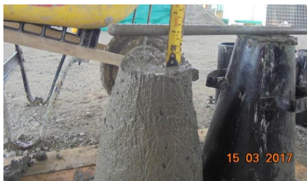
Figura 25. Chequeo de asentamiento del concreto de la placa de contrapiso. Fuente Contrato 1318-2013
