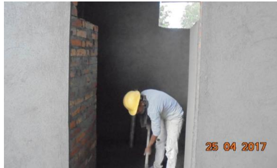
Figura 38 Repello en muros de las baterías sanitarias. Fuente Contrato 1318-2013
