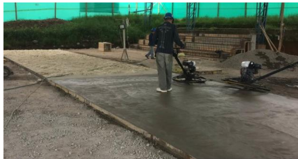
Figura 28 Pulido del concreto con helicóptero de la placa de contrapiso. Fuente Contrato 1318-2013
