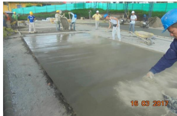
Figura 27 Aplicación producto endurecedor para el pulido del concreto con helicóptero de la placa de contrapiso. Fuente Contrato 1318-2013
