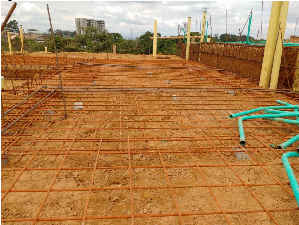
Figura 27. Mala ubicación de acero de refuerzo en losa de cimentación
