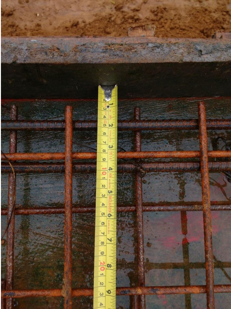
Figura 69. Corrección en la separación del refuerzo en V4
