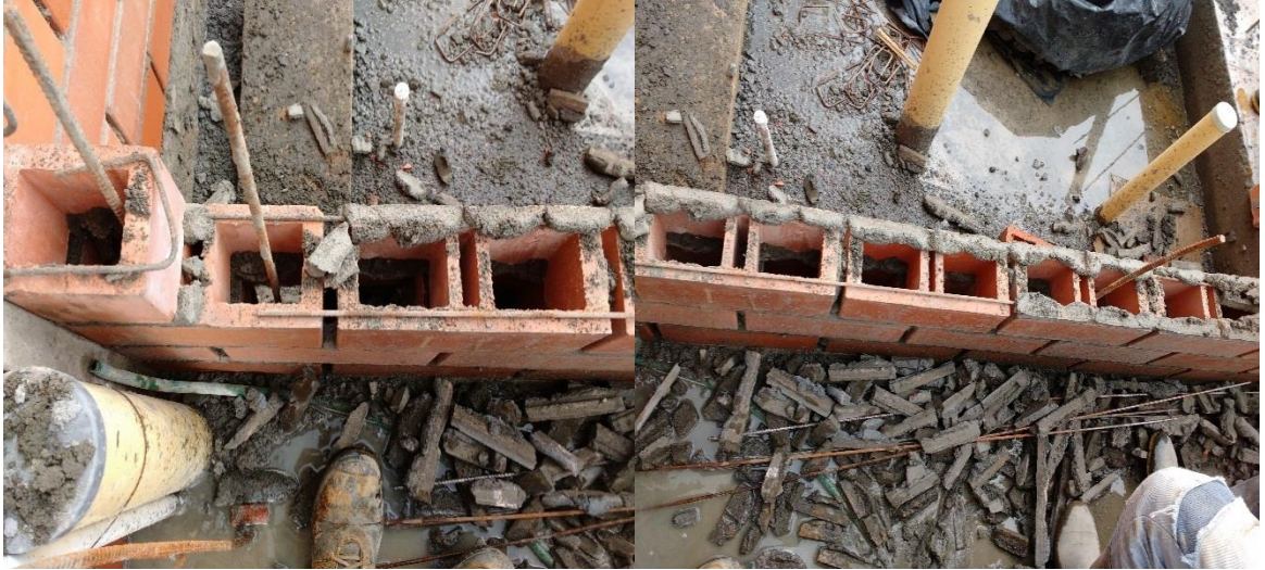
Figura 59. Mal procedimiento de instalación de grafiles .
