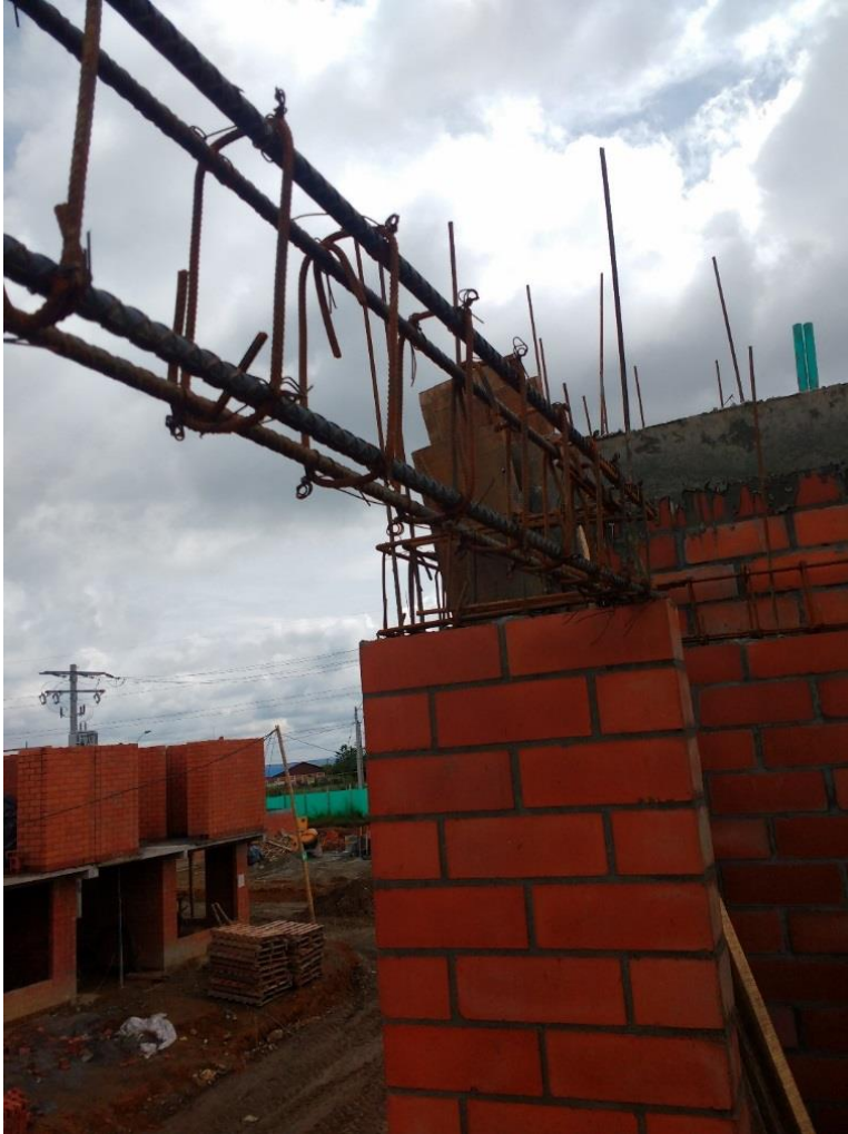
Figura 70. Mala ubicación de acero de refuerzo a flexión
