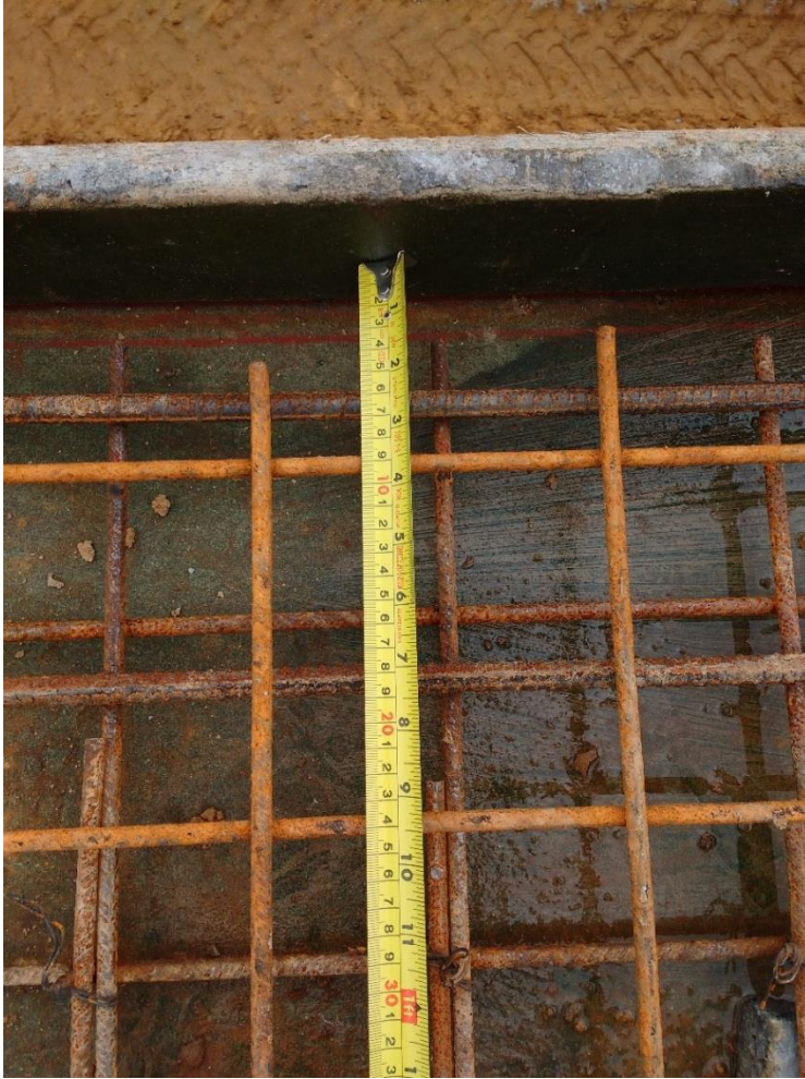
Figura 68. Mala separación en acero de refuerzo en corte V4 eje 0 entre A-C
