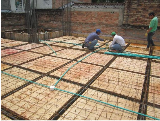
Foto 48: Ubicación de malla y tubería eléctrica.
