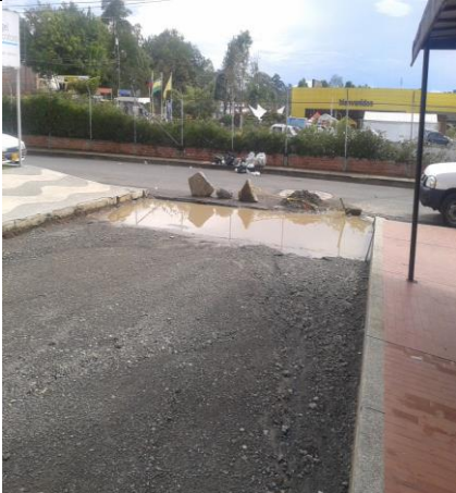
Sub base despues de aguacero
