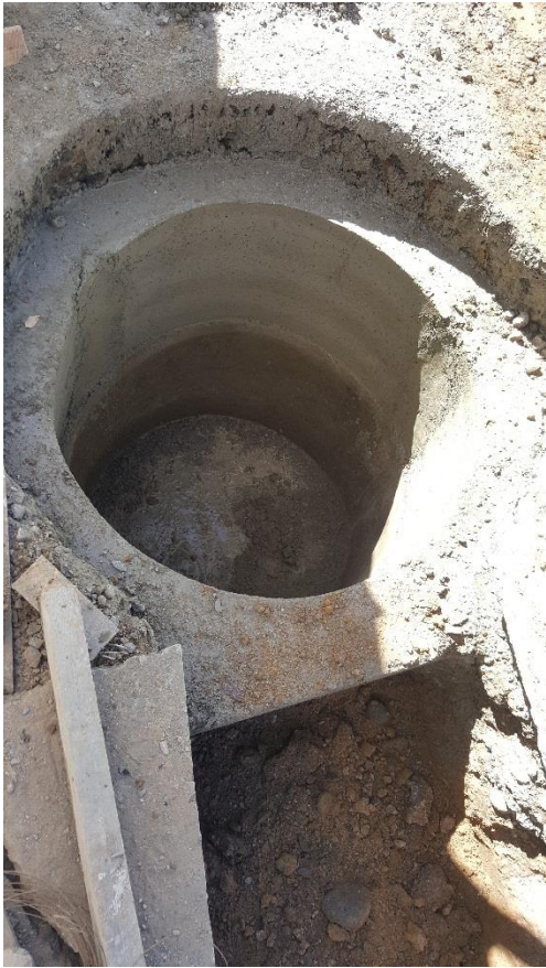
Figura 36. Cámara de inspección. (Fuente: Propia)
