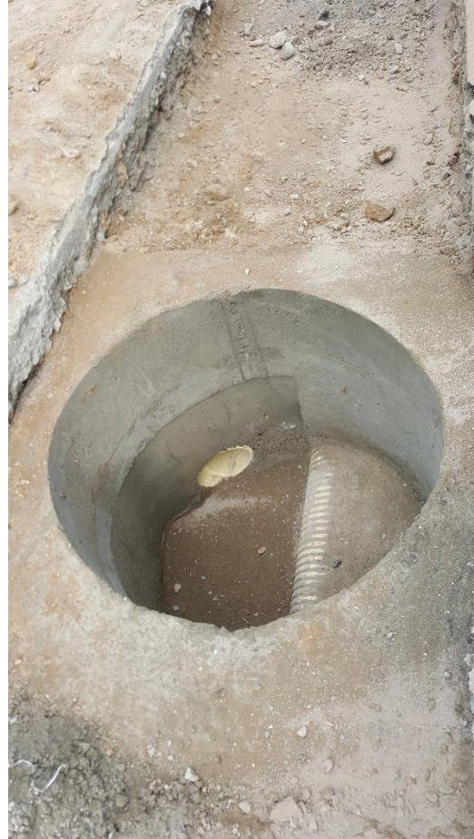
Figura 44. Cámara de inspección. (Fuente: Propia)
