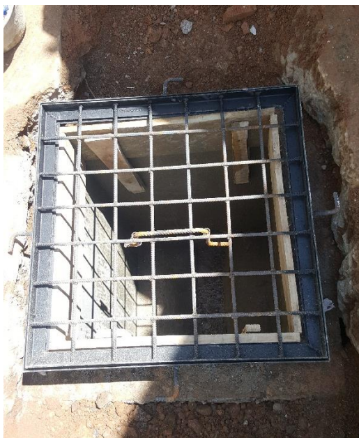
Figura 53. Tapa caja de inspección. (Fuente: Propia)
