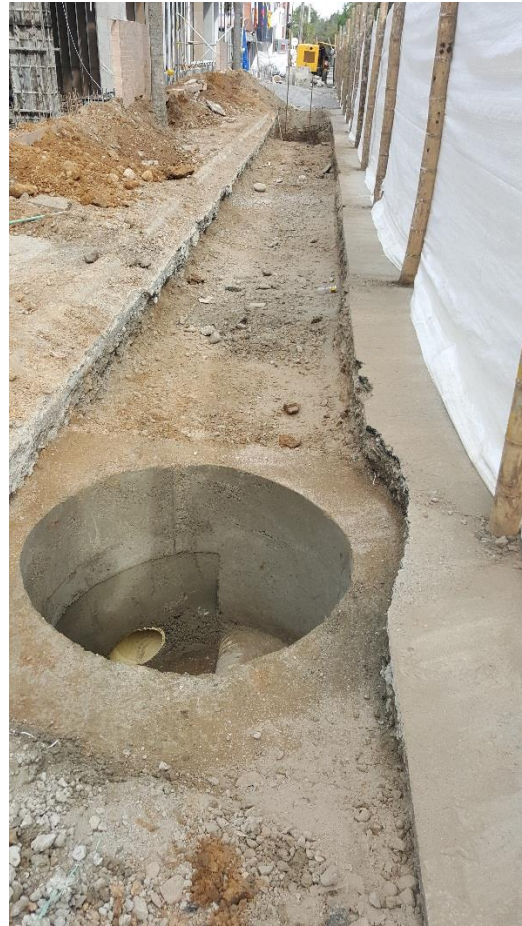
Figura 46. Cámara de inspección. (Fuente: Propia)
