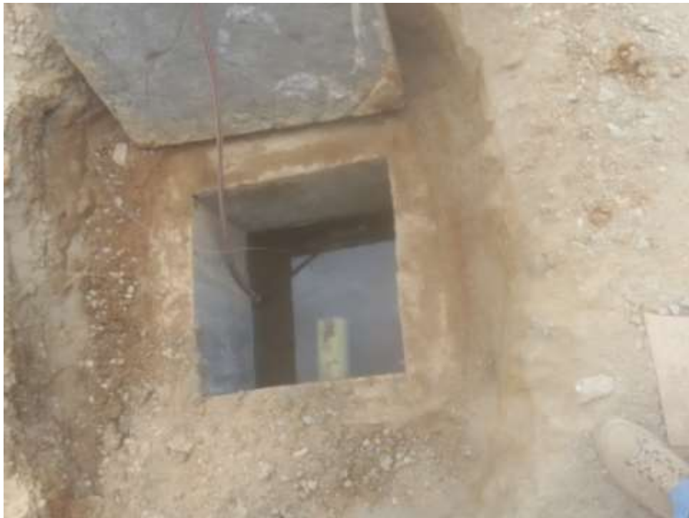
Figura N° 22: Cámara de inspección módulo 5 casa 2
