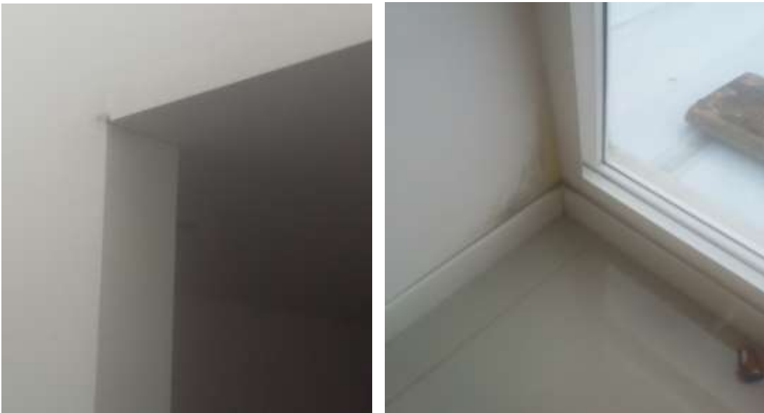
Figura N° 31: Falencias en módulo 3 casa 1
