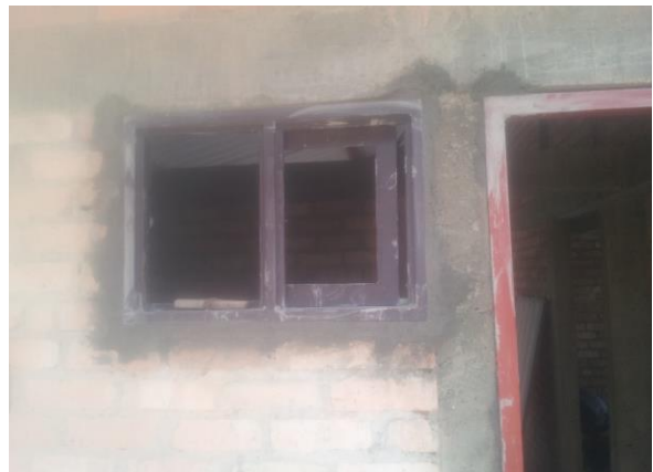
Foto 64. Ventana y puerta fundidas y sin limpiar. Fuente Construcción propia.
