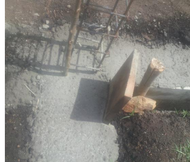
Foto 21. Viga con sobre ancho. Fuente Construcción propia
