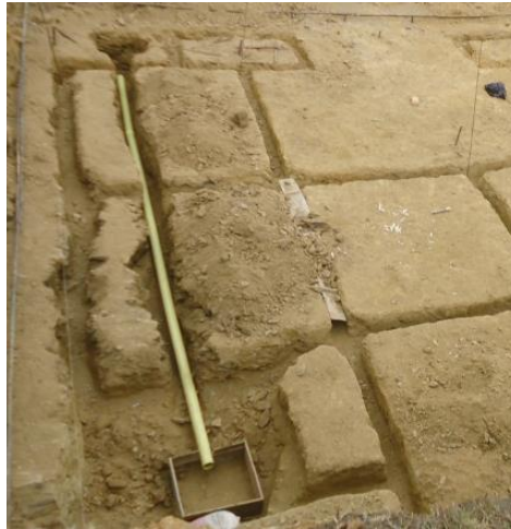
Foto 50. Localización de tubería sanitaria de Ø4”.
