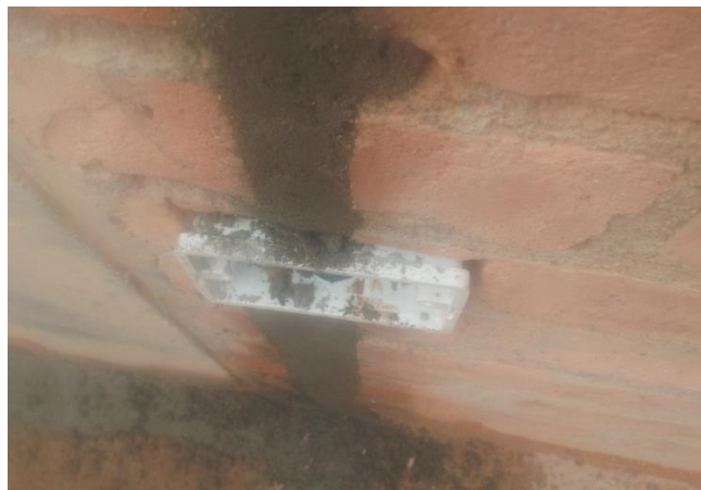
Foto 67. Caja y emboquillado en mal estado. Fuente Construcción propia.
