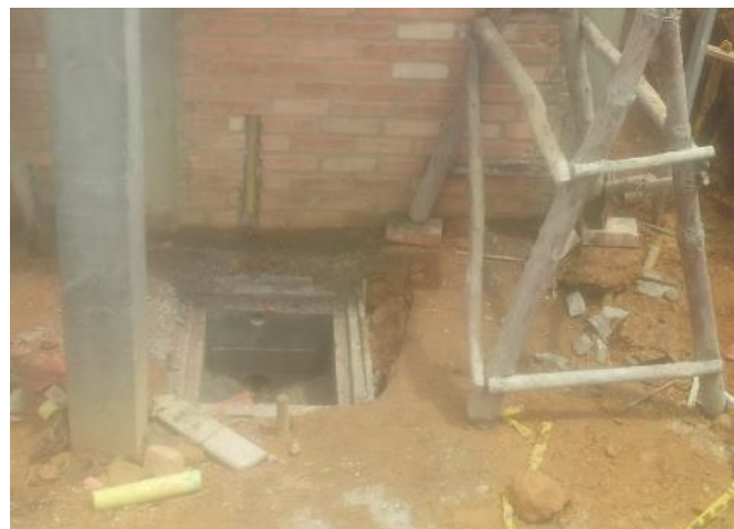
Foto 49. Caja de inspección delantera. Fuente Construcción propia
