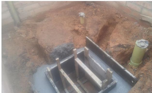
Foto 53. Instalación sanitaria en baño. Fuente Construcción propia
