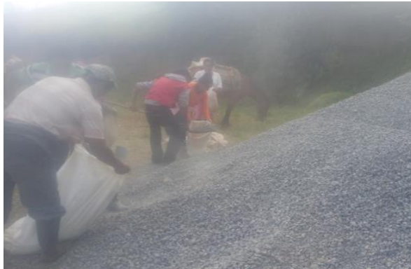
Foto 4. Minga realizada para transportar triturado hasta el lugar de la obra. Fuente Construcción propia
