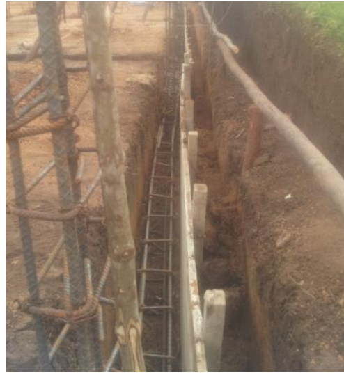
Foto 11. Detalle de sobre excavación. Fuente Construcción propia
