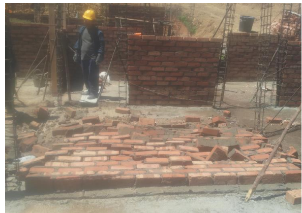
Foto 25. Muro derribado por acción del viento. Fuente Construcción propia
