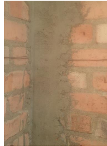
Foto 31. Columnetas con rebaba. Fuente Construcción propia.
