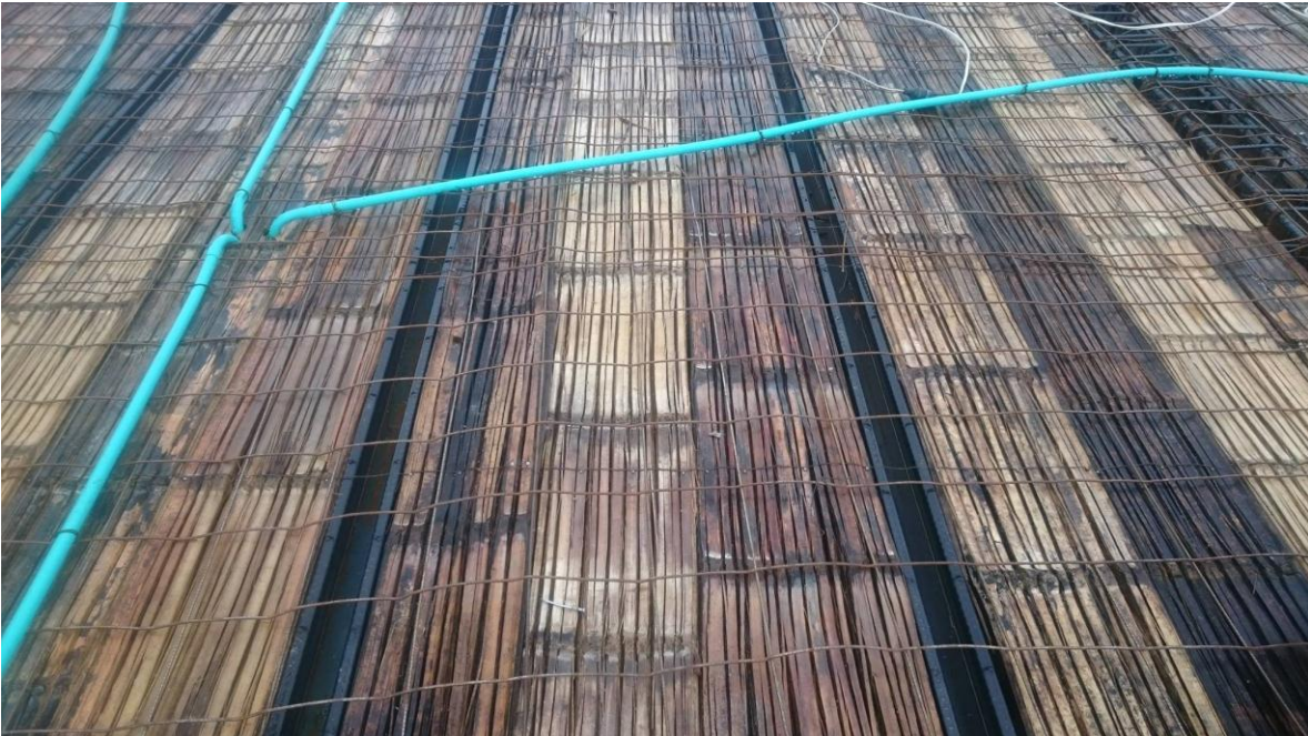
Figura XXXI Vista superior de losa de entrepiso antes del vaciado del concreto. Fuente: Propia
