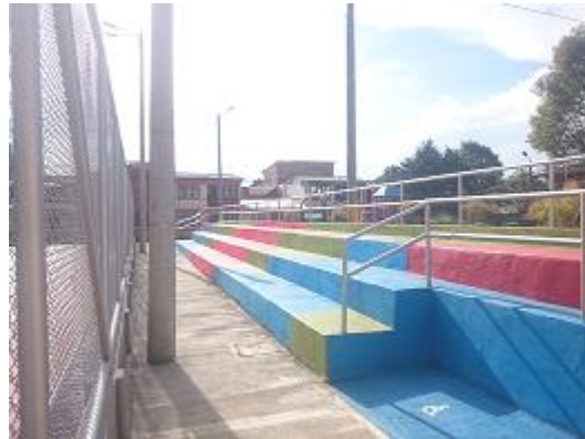
Figura 110 Graderías con baranda de seguridad /fuente: Propia.
