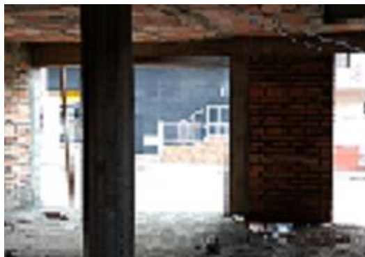
Figura 4 Falta de ejes y deformación de losa de entrepiso (Aligerada) /fuente: Propia
