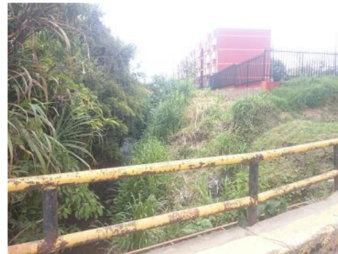
Figura 94 Pérdida de banca (rio molino) /fuente: Propia.
