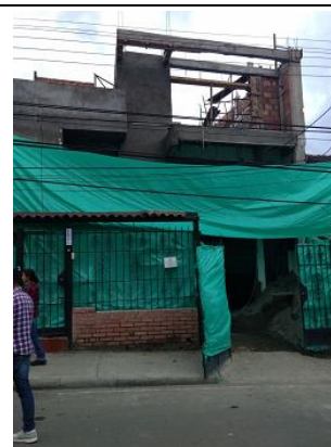
Figura 96 Edificación sin licencia de construcción /fuente: Propia.
