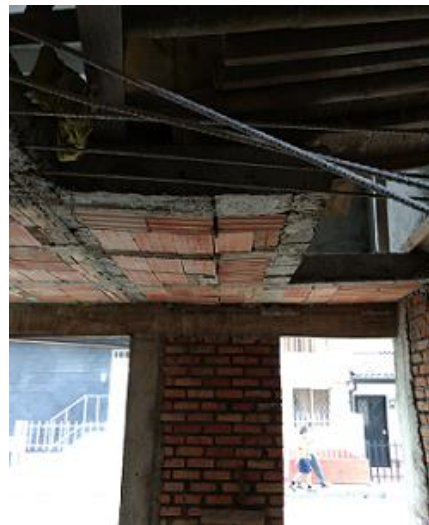
Figura 5 Deformación losa aligerada /fuente: Propia
