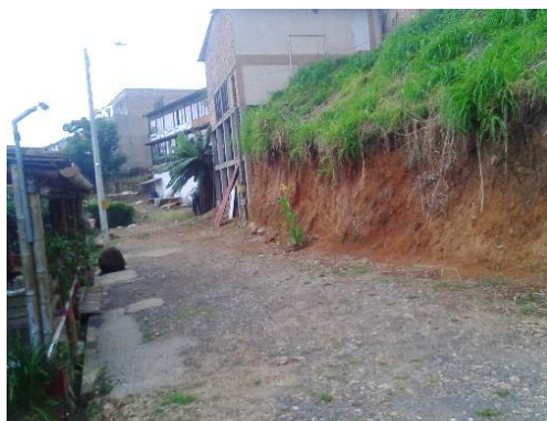
Figura 83 Terraplén erosionado /fuente: Propia.
