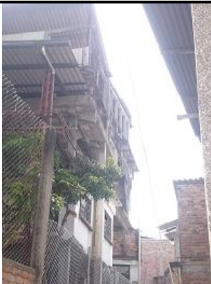
Figura 87 Edificación de cuatro (4) pisos en ruinas /Fuente: Propia.
