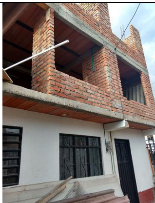
Figura 95 Edificación sin licencia de construcción /fuente: Propia.
