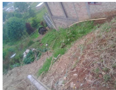
Figura 84 Terraplén erosionado /fuente: Propia.
