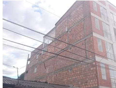
Figura 86 Posible falta de columnas en el segundo (2) y tercer (3) piso /fuente: Propia.
