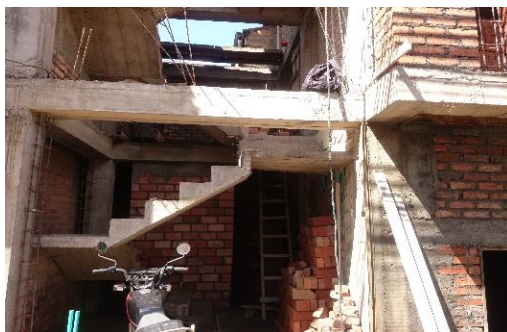
Figura 35 Muro confinado no existente en planos arquitectónicos /fuente: Propia.
