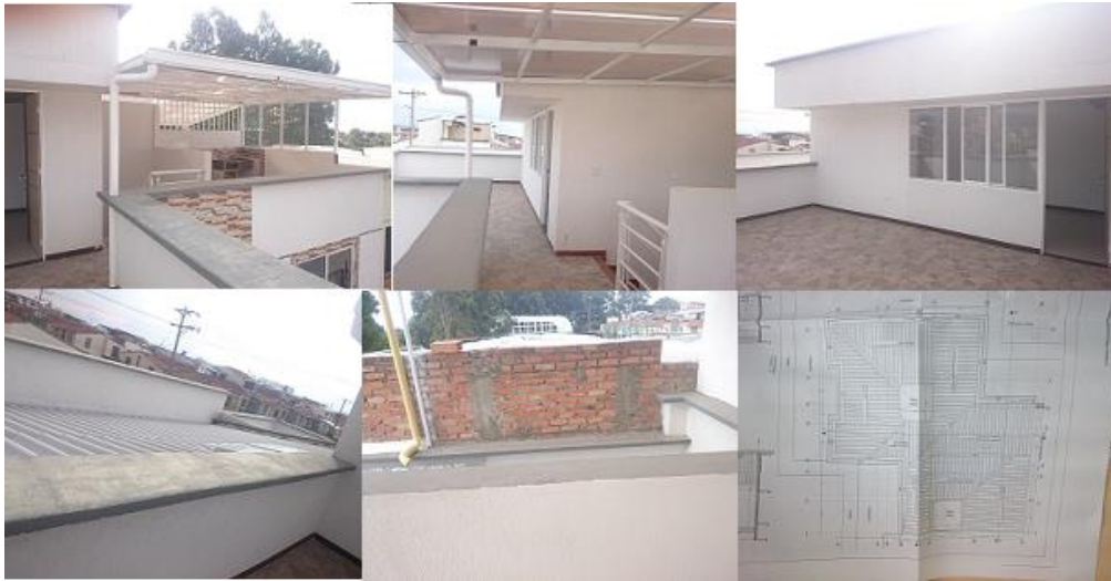
Figura 65 Tercer piso no previsto en el diseño estructural /fuente: Propia.
