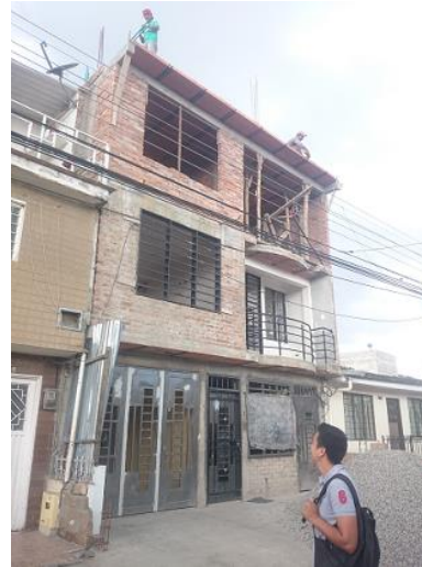
Figura 17 Construcción de tres pisos sin la aprobación de curaduría /fuente: propia.
