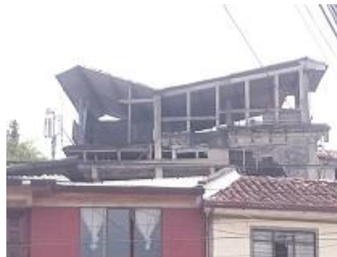
Figura 88 Posibles fallas estructurales por abandono de la edificación /fuente: Propia.
