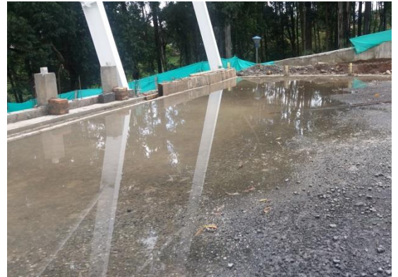
Foto 42: Empozamiento de agua en uno de los costados de la cancha múltiple.
