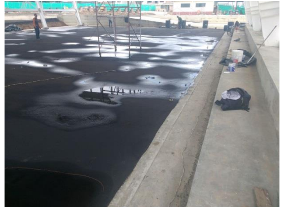
Foto 64: Charquitos con agua de los leves hundimientos.
