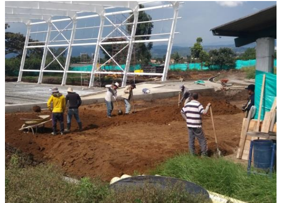
Foto 45: Obreros trabajando sin los elementos de protección.
