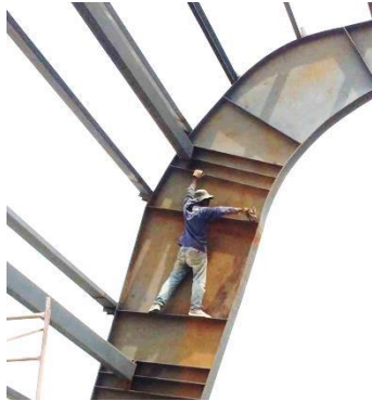
Foto 44: Obrero sin elementos de protección haciendo trabajo en alturas.
