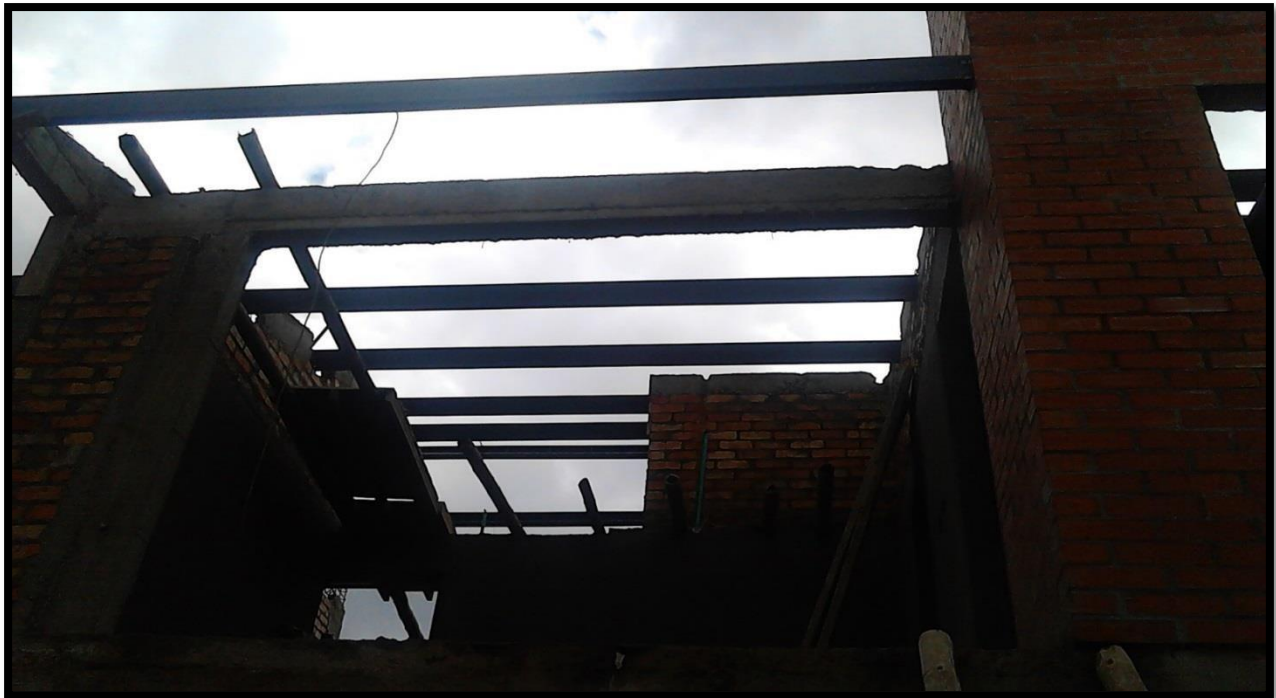
Foto 11. Perlineria colocada sobre cintas de amarre o vigas de cubierta, imagen de archivo de obra
