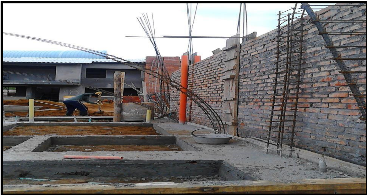
Foto 9. Castillos de acero para columnetas de muros perimetrales, imagen de archivo de obra.
