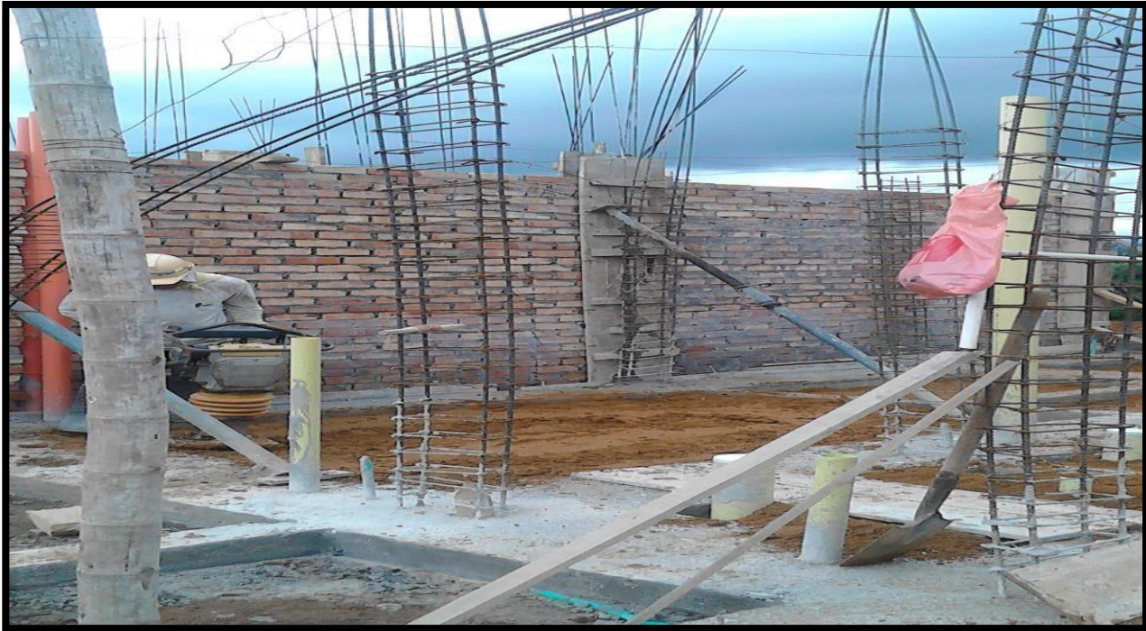
Foto 10 .Castillos de acero para columnetas de muros divisorios, imagen de archivo de obra
