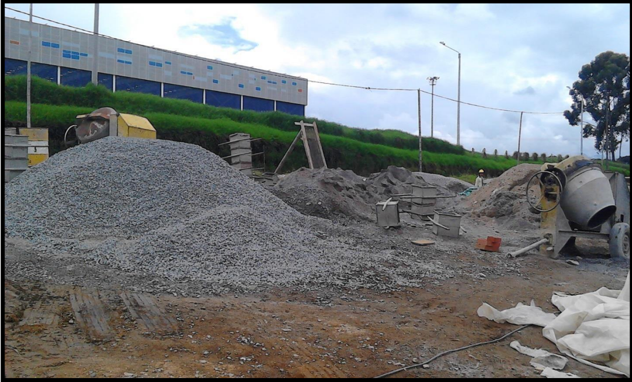
Foto 18. Acopio de triturado, arena fina y media. imagen de archivo de obra
