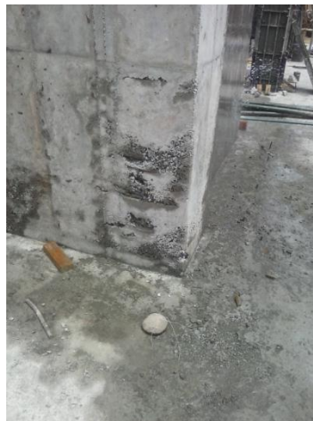
Figura 36. Errores en la fundición (Hormigueros). Fuente: El autor.
