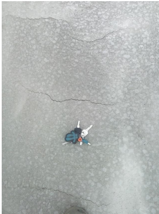
Figura 52. Fisuras encontradas en la losa de entrepiso.
