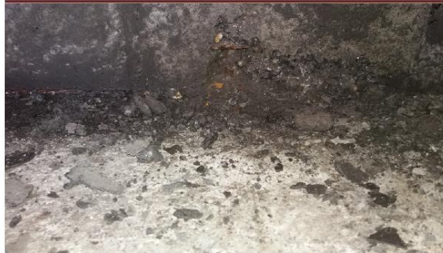
Foto 2: aceros expuestos habitación 2 apto 702 , torre C.
