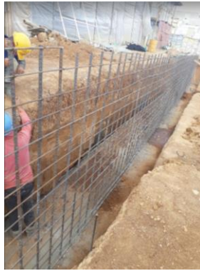
Figura 50: Desmoronamiento de suelo
