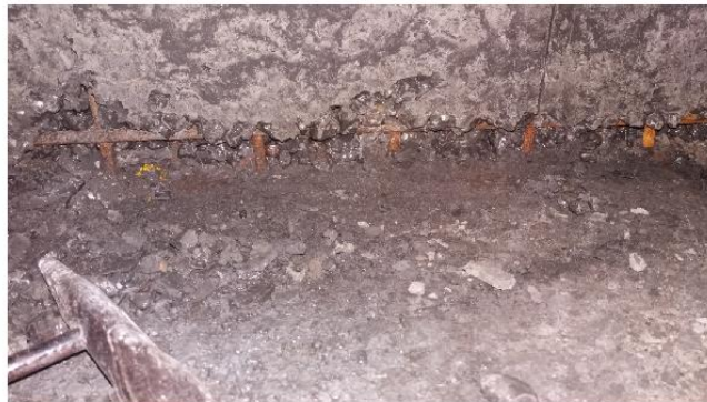
Foto 3: Agujero y aceros expuestos baño social apto 702, torre C.
