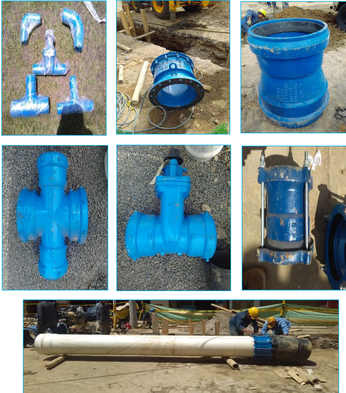
Imágenes 41 – 47 accesorios varios en HF y/o HD Red distribución acueducto.
