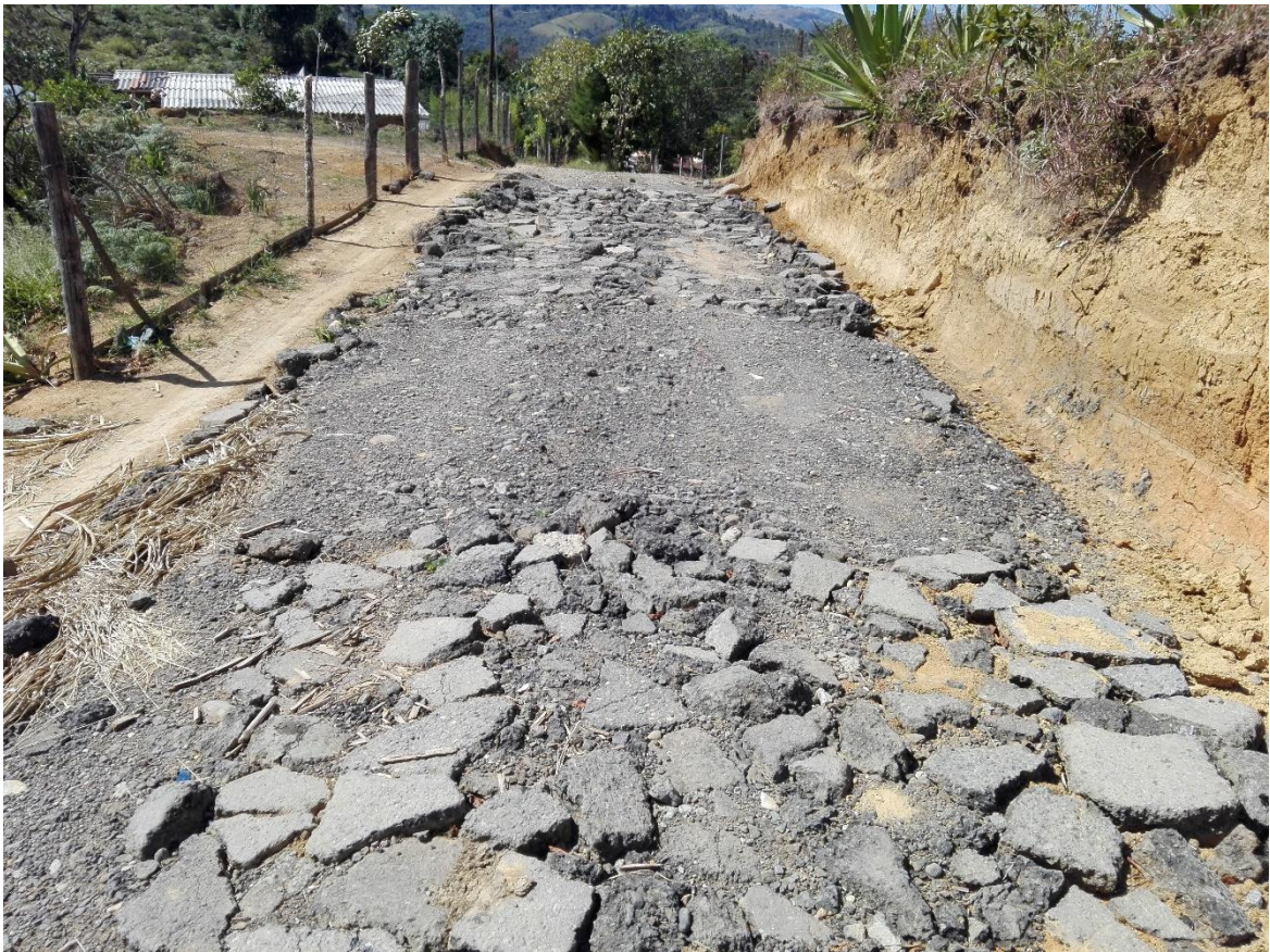
Figura 14. Presencia de material mal acomodado en la vía
