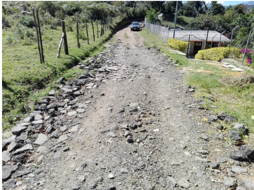
Figura 16. Presencia de material mal acomodado en la vía
