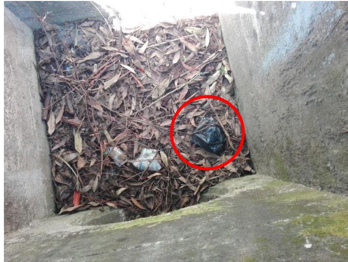
Figura 12. Alcantarilla con presencia de material vegetal, sedimentos y residuos
