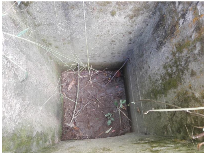
Figura 13. Alcantarilla con presencia de sedimentos
