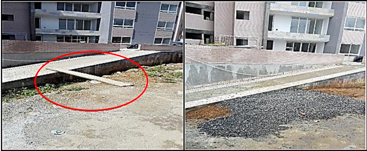
Figura 79 Corrección de condición insegura
