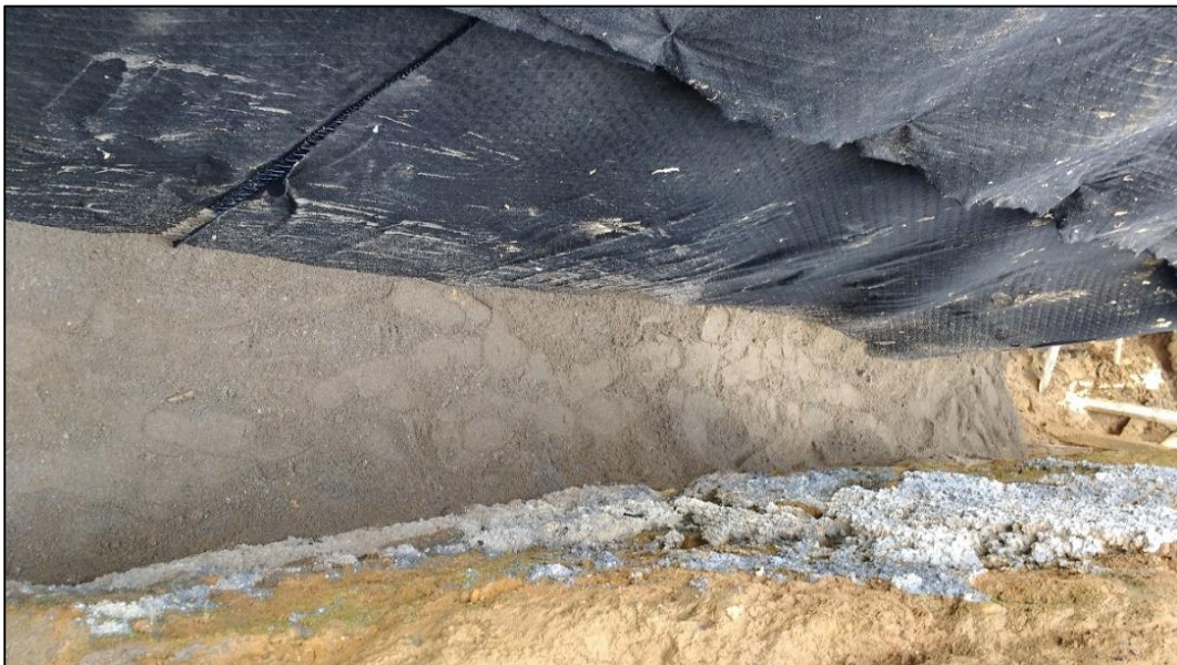
Figura 42 Filtro de arena
