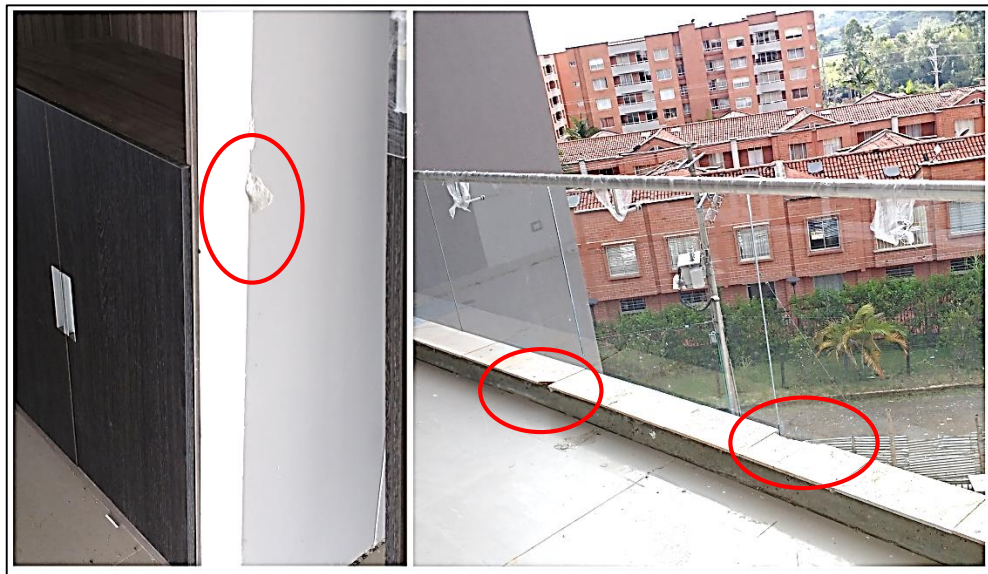
Figura 78 Fichas de mármol y esquina de muro a reparar
