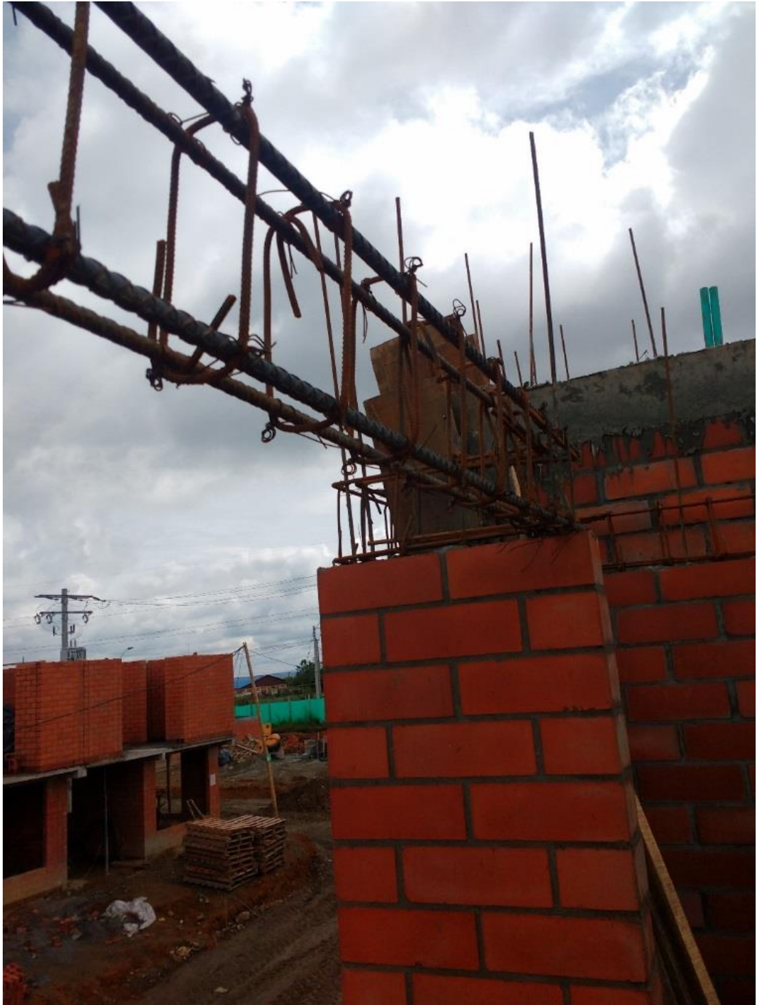
Figura 68. Mala ubicación de acero de refuerzo a flexión
