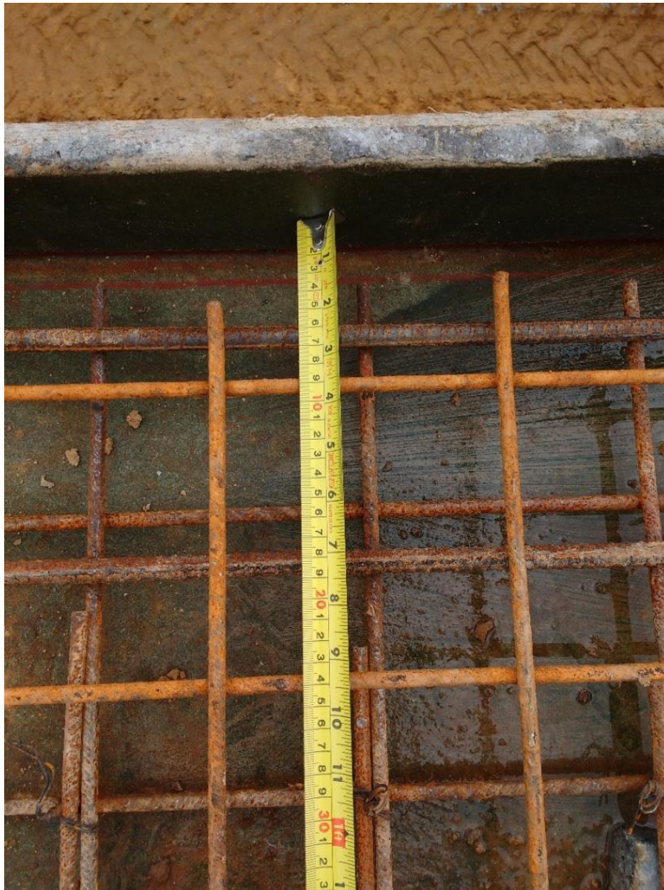
Figura 316. Mala separación en acero de refuerzo en corte V4 eje 0 entre A-C
