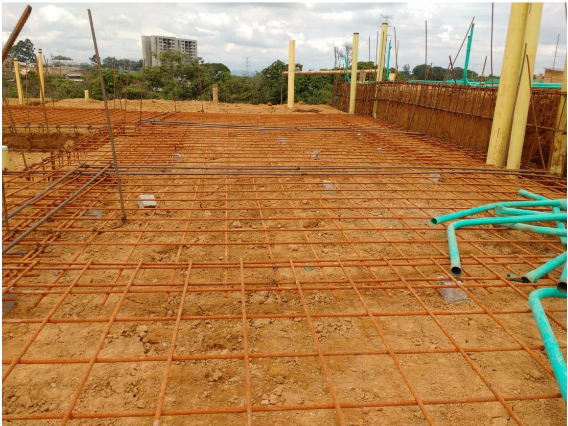
Figura 86. Mala ubicación de acero de refuerzo en losa de cimentación.
