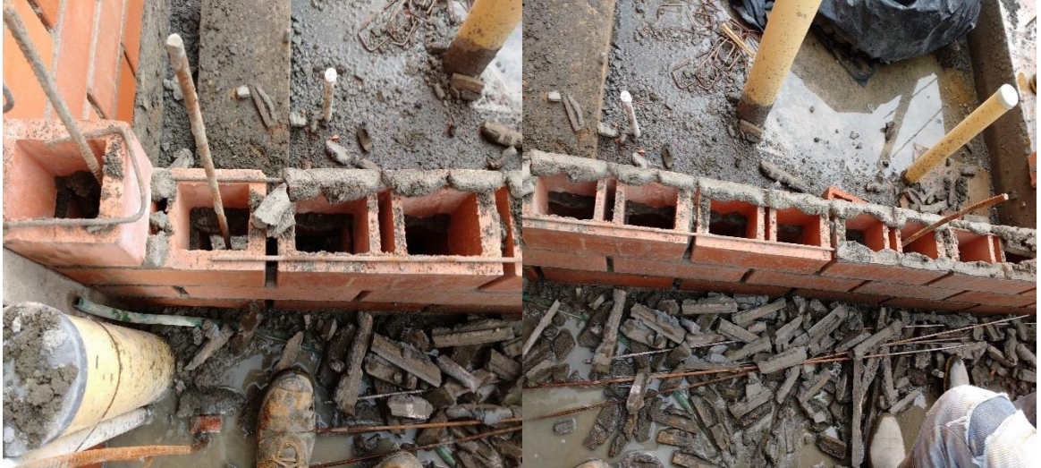
Figura 247. Mal procedimiento de instalación de grafiles .
