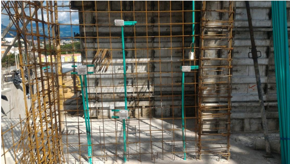
Figura N° 18: Tubería eléctrica y de telecomunicaciones en pantallas.
