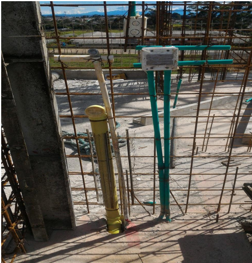
Figura N° 20: Tubería de presión en PVC.
