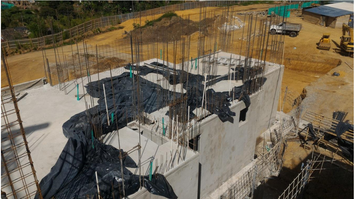
Figura N° 7: Continuación de elementos de borde.
