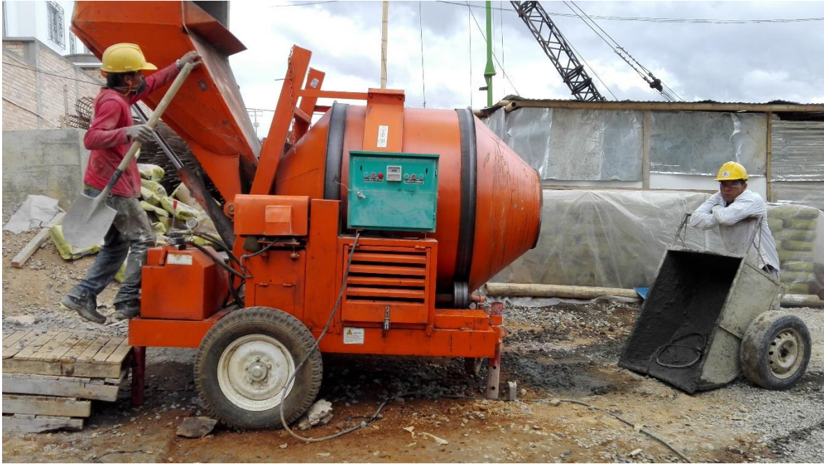
Fotografía 20. Mezcladora. Fuente: Tomada por el pasante
