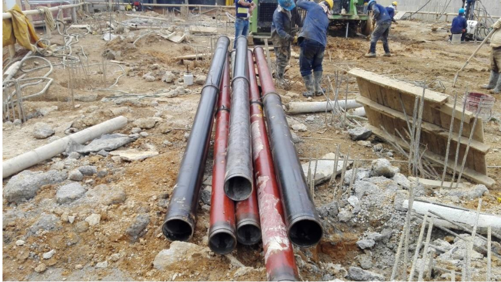
Fotografía 47. Tubería de fundición. Fuente: Tomada por el pasante
