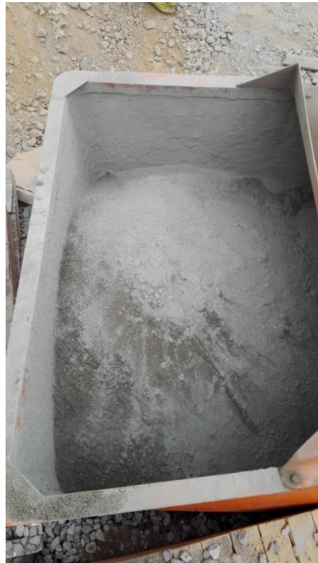
Fotografía 21. Materiales en la tolva de la mezcladora. Fuente: Tomada por el pasante
