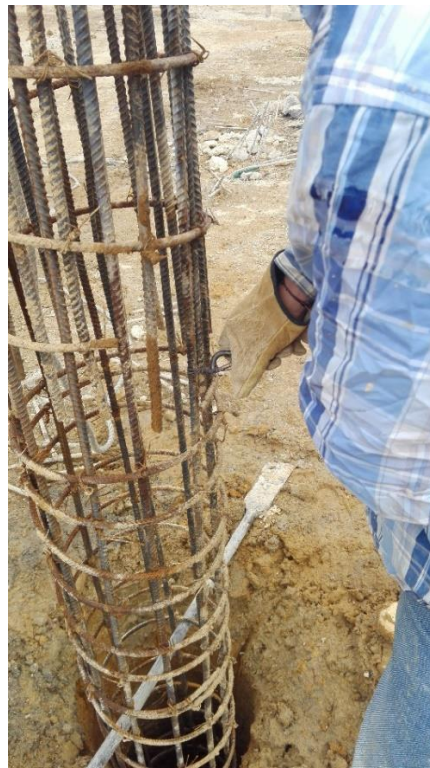
Fotografía 46. Amarre y traslapo de castillos. Fuente: Tomada por el pasante
