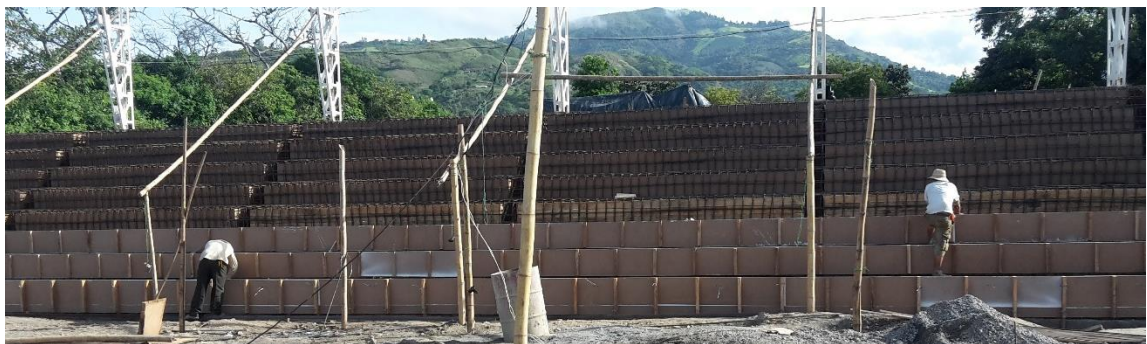
Ilustración 25. Instalación del MDF
