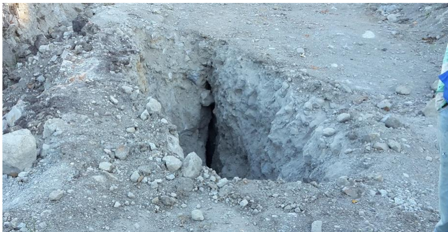
Ilustración 7. Grietas encontradas en obra.
