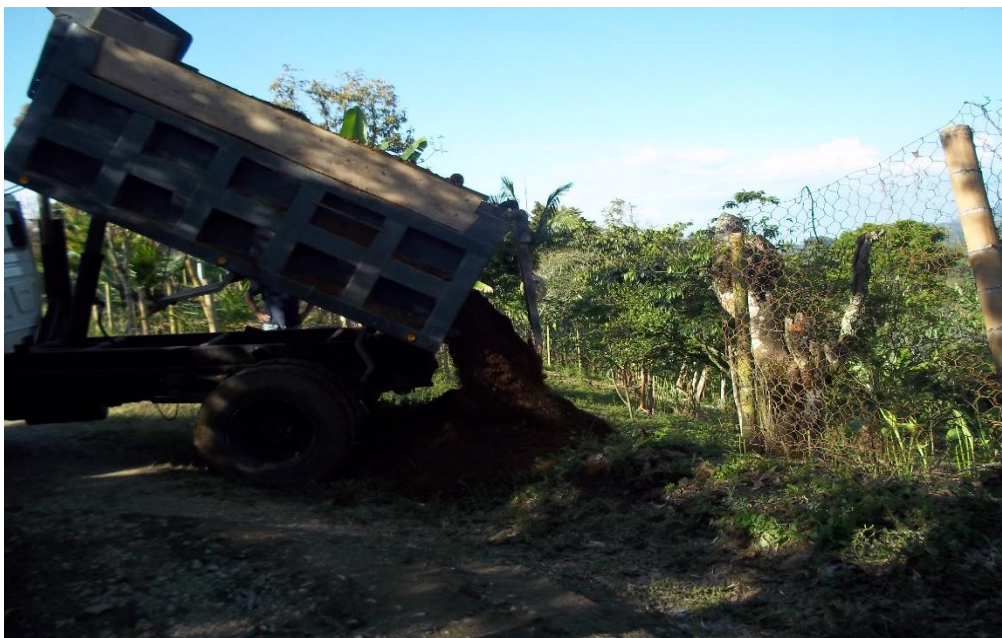
Figura 17. Retiro de material de excavación tramo 3, Reten de las Arepas – Crucero del Rosario
