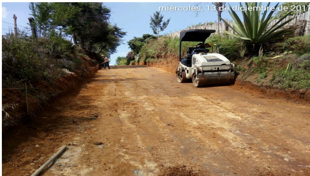
Figura 12. Uso del vibro compactador para la compactación de subrasante tramo 1 Corregimiento de Siberia - Cementerio.
