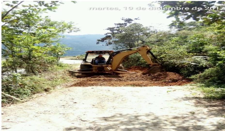
Figura 16. Excavación de sub rasante tramo 3, Reten de las Arepas – Crucero del Rosario.
