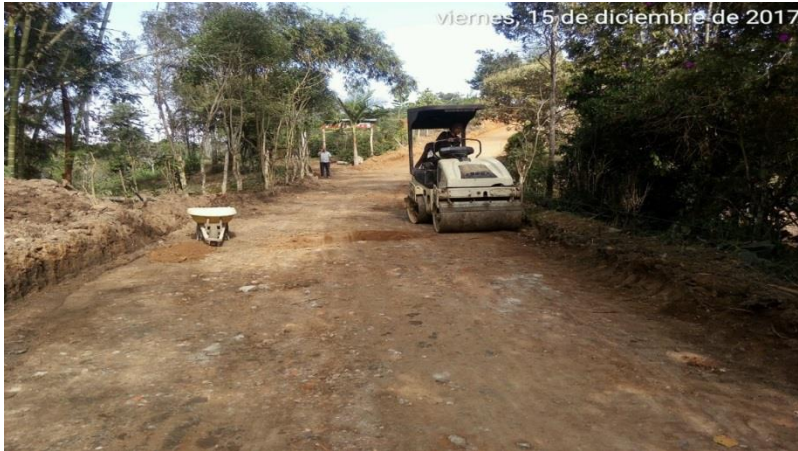
Figura 13. Uso del vibro compactador para la compactación de sub rasante tramo 1 Corregimiento de Siberia - Cementerio.
