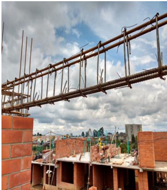
Figura 47. Corrección acero viga de amarre
