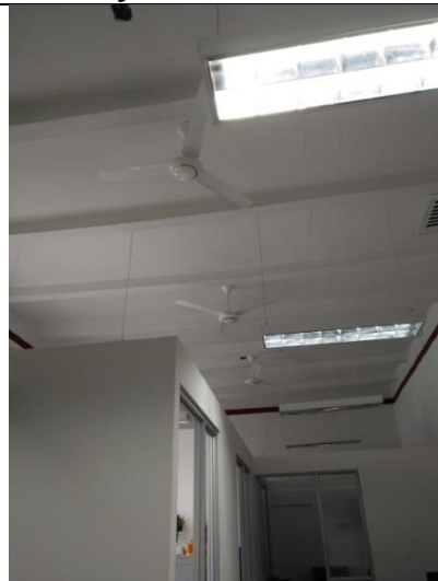
Figura 4.6 Ventiladores y lámparas ya instaladas
