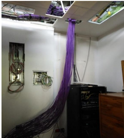
Figura 4.50 Cuarto de cableado, ubicado en la sala de profesores.
