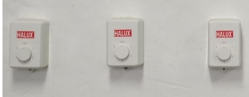
Figura 4.7. Interruptores para los ventiladores instalados.
