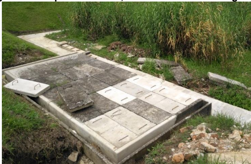
Figura 4.56 Tapa de la PTAR, Facultad de ciencias agrarias.
