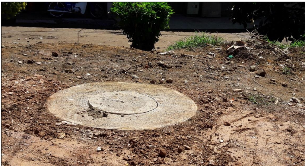
Figura 2. Socialización de la obra, localización trazado y replanteo de conducciones de alcantarillados.
