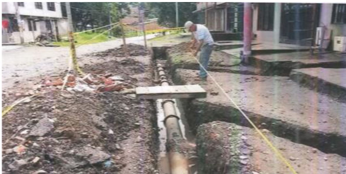
Figura 34. Tubería de concreto existente expuesta con la excavación, para su posterior retiro.
