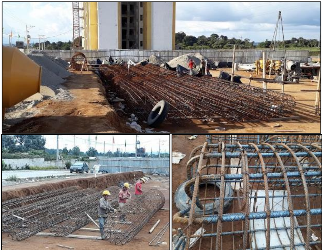
Figura 45. Armado del refuerzo para los caissons de la cimentación profunda de la torre B.
