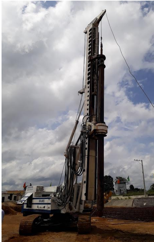
Figura 47. Piloteadora Soilmec R-12.
